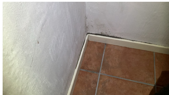
Fuktinntrekk på muren bak sofaen i kjelleren
