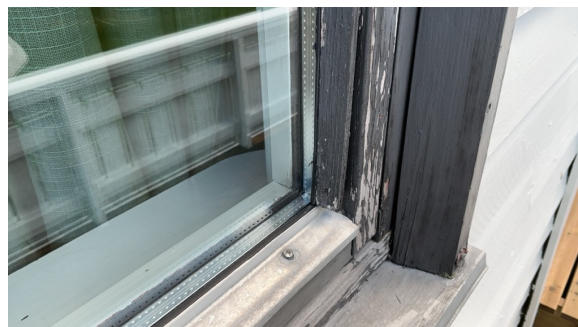
Mye slitasje og antydning til noe råteskade
