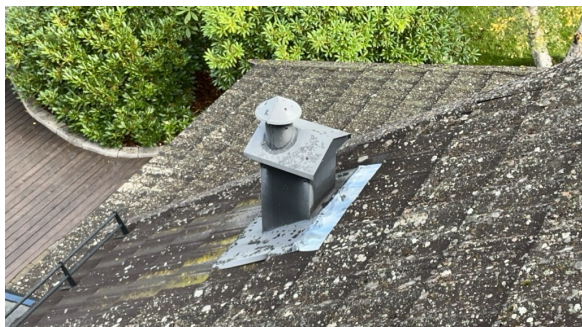
Slitasje på luftehatt
