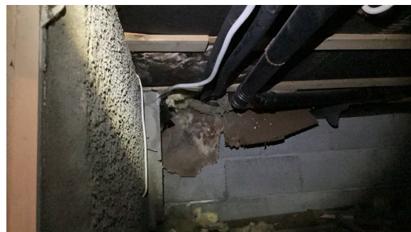
Fuktskader i gulvet fra vaskerommet over
