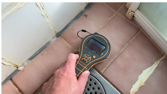
Store fuktutslag i dusjen
