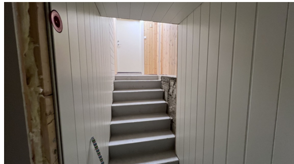
Mangler rekkverk/håndløper i trappen
