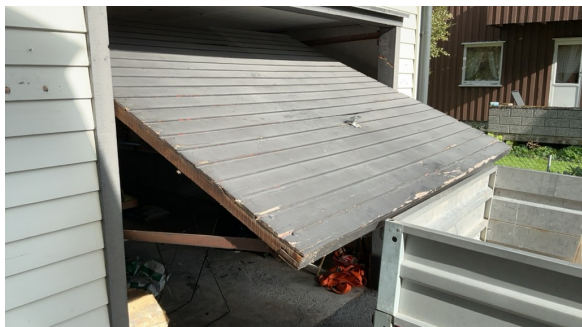
Garasjeporten med hakk og slitasje
