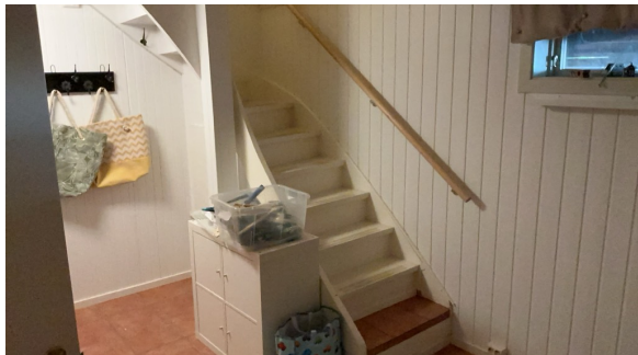
Mangler rekkverk på deler av trappen
