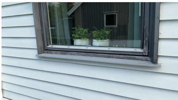
Stor slitasje på vinduene
