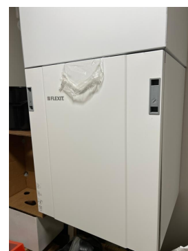
Balansert ventilasjonsanlegg i bod.
