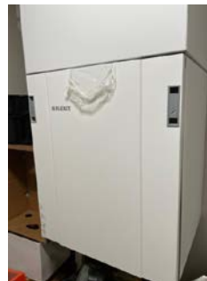
Balansert ventilasjonsanlegg i bod.
