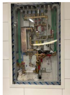
Rør i rør og varmeskap på badet.
