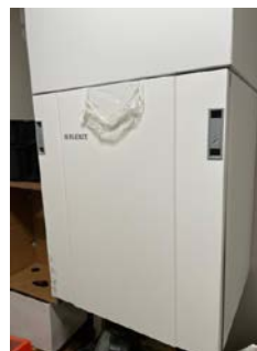
Balansert ventilasjonsanlegg i bod.
