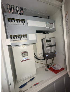
Sikringsskap med automatsikringer.
