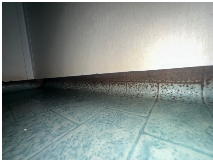
Synlig svartsopp på belegg
