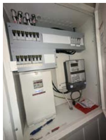
Sikringskap med automatsikringer.
