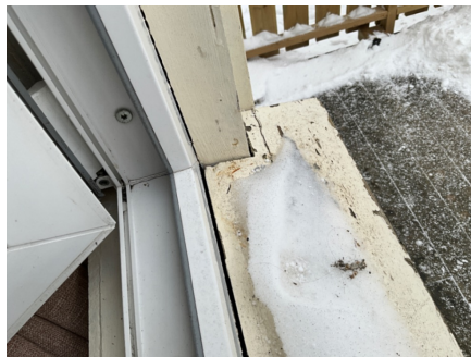
Glipe mellom vannbrett og vindu.
