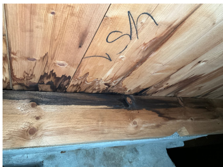
Utettheter rundt pipe gjennomføringen.
