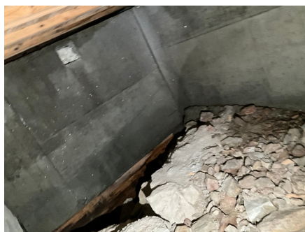
Råteskadet treverk på innsiden.
