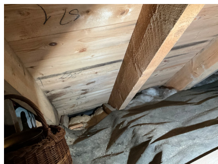
Vått i deler av undertaket.
