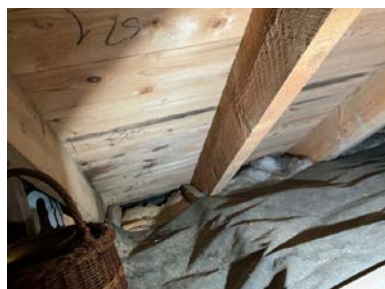
Vått i deler av undertaket.
