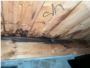
Utettheter rundt pipe gjennomføringen.
