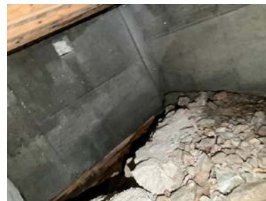
Råteskadet treverk på innsiden.
