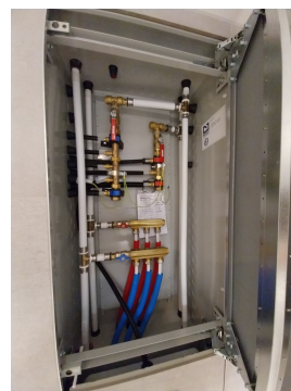
Fordelerskap med flislagt pop-up dør plassert på bad.
