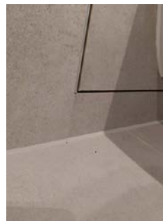
Etablert overløp til gulv med sluk via spalte under veggghengt toalett.
