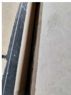
Manglende beslag mellom yttervegg og balkong.
