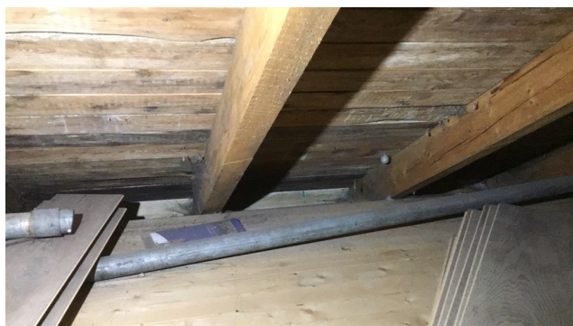
begrenset lufting i nedkant
