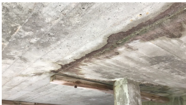
Underkant støpt terrasse i 1 etg med sprekk i betongdekke
