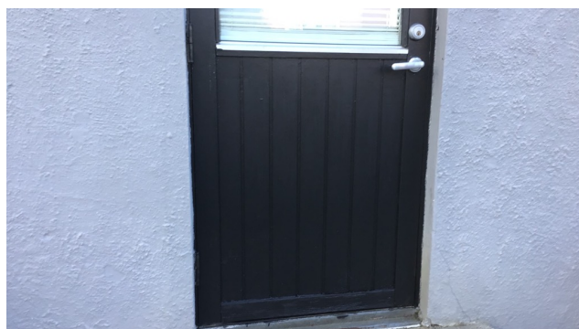
Fukt skader i nedkant dørspeil
