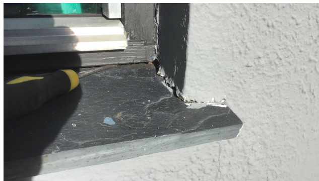
Utettheter rundt vinduer i mur
