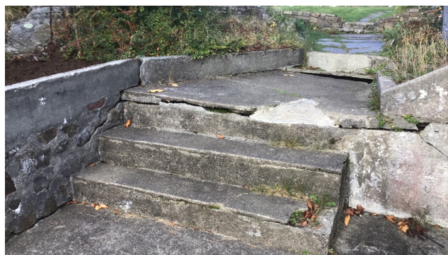
Sprekker og skader i trapp
