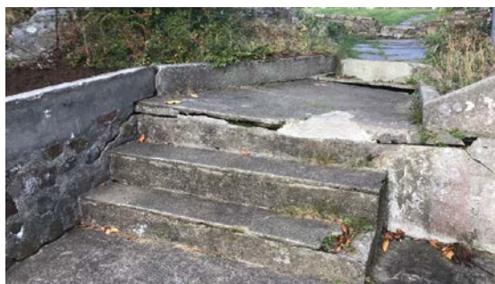
Sprekker og skader i trapp
