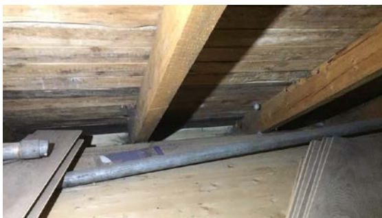
begrenset lufting i nedkant
