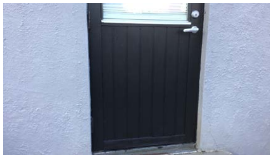
Fukt skader i nedkant dørspil
