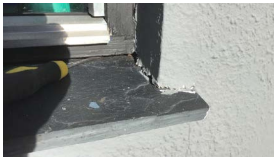
Utettheter rundt vinduer i mur
