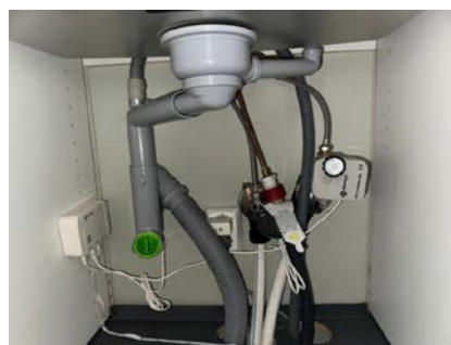
Røropplegg i kjøkkenbenk med Waterguard
