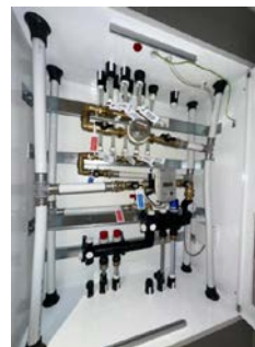
Samleskap med rørkurser og stoppekraner
