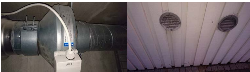
Kraftig avtrekk fra boder
