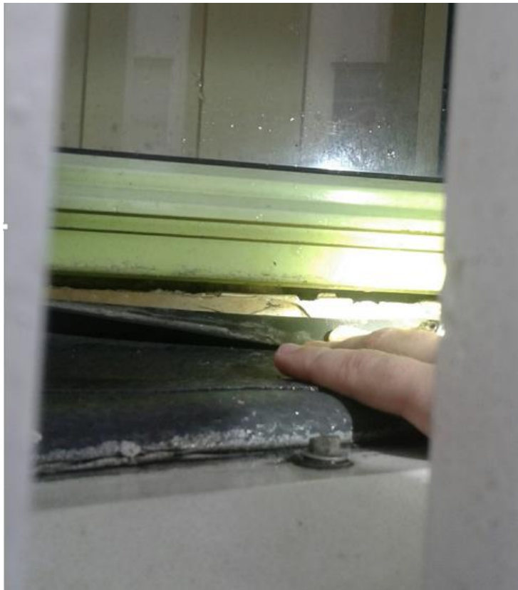
Her ser vi en dårlig løsning på membran under en terrassedør.
