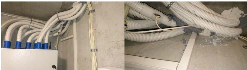
Ikke fagmessig brannetting.
