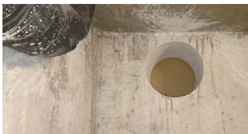
Tilførsel tettet av bruker.
