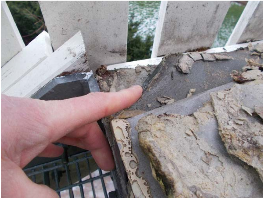
Enkelte fliser ligger løst, type membran og avslutning av membran er uheldig.
