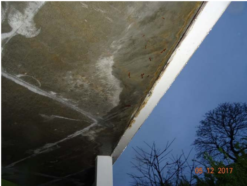
Dårlig avslutning av membran på opp siden her fører til mye fukt i ytre del av dekket.
