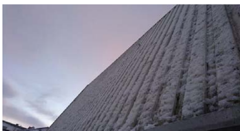
Sprinkler med ukjent frostsikring.
