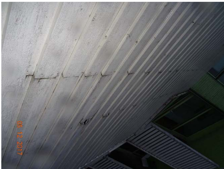
Der er noe råteskader i kledning, hovedsakelig i skjøter.
