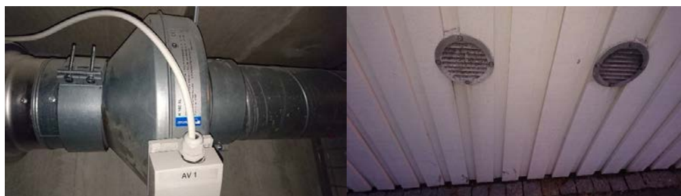
Kraftig avtrekk fra boder
