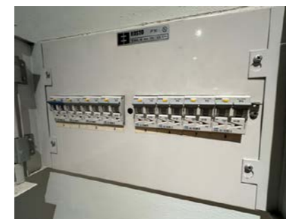
Sikringsskap med automatsikringer.
