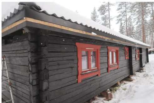
Bilde viser manglende takrenner.
