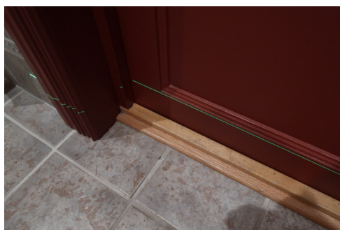
Bilde viser manglende tilluftsmulighet til rommet.
