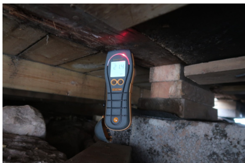
Bilde viser skadelig fukt i krypekjeller. Bilde er tatt under inngangsdør til entré.
