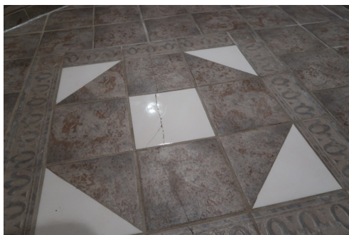
Bilde viser sprekkdannelse i gulv.
