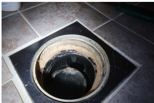
Bilde viser sluk uten montert klemring.
