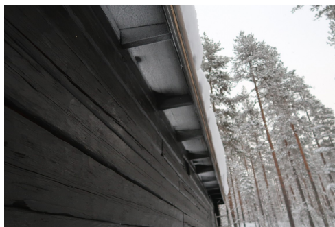
Bilde viser rim- og isdannelser i takutstikk.
