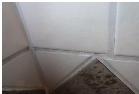
Bilde viser sprekk mellom fliser i dusjsonen.
