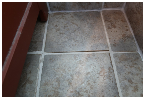
Bilde viser sprekkdannelse i gulv.
