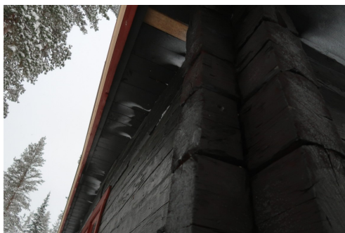
Bilde viser rim- og isdannelser i takutstikk.
