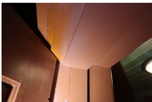
Bilde viser manglende tettelister mellom dør og dørkarm.
