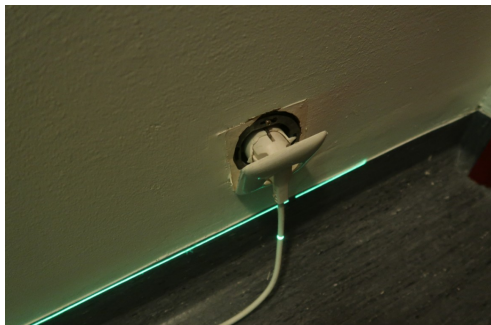
Bilde viser løs stikkontakt på teknisk rom.
