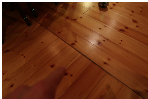
Bilde viser tregulv i stue/ kjøkken med svikt.
