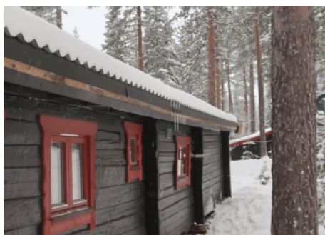
Ising på yttertak over teknisk rom.
