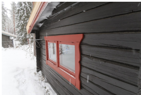
Bilde viser manglende beslag over og under vindu.
