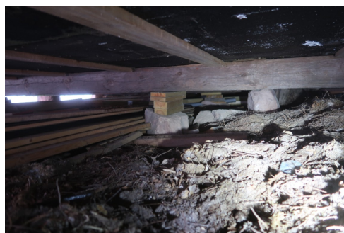
Bilde viser tegn på oppretting.
