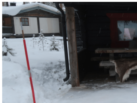
Bilde viser nedløpsrør med ikke tilfredsstillende bortledning av vann.
