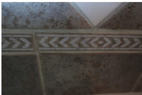
Bilde viser sprekk mellom fliser i dusjsonen.
