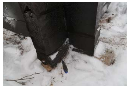
Bilde viser råteskadet treverk i hjørne mot nordøst.
