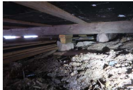
Bilde viser tegn på oppretting.
