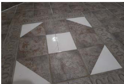
Bilde viser sprekkdannelse i gulv.
