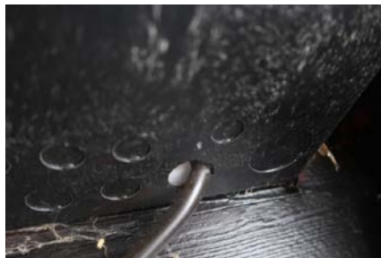
Bilde viser eksempel på utetthet ved kabelinnføring i utvendig sikringsskap.
