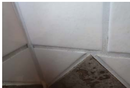
Bilde viser sprekk mellom fliser i dusjsonen.
