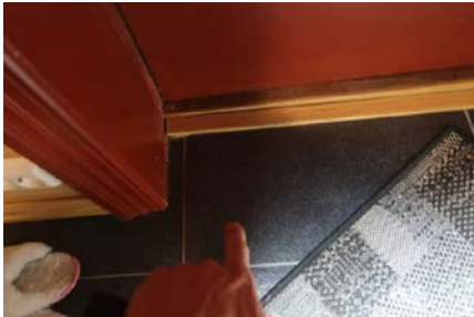
Bilde viser bom/ hulrom under flis i entré.
