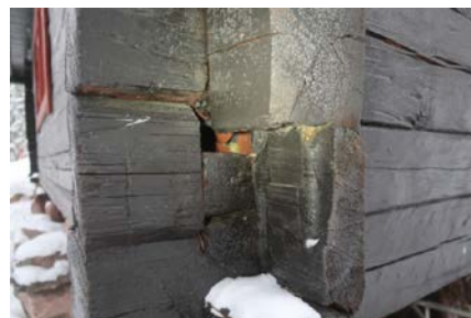
Bilde viser utettheter og skader i lafteknuter. Bilde er tatt av hjørne mot sørvest.
