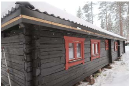
Bilde viser manglende takrenner.
