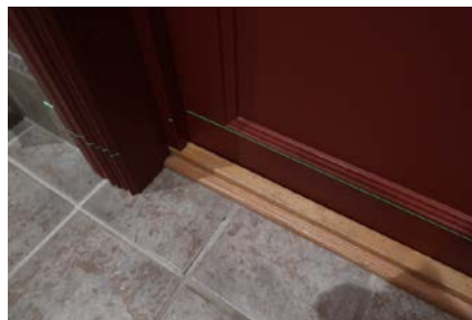
Bilde viser manglende tilluftsmulighet til rommet.
