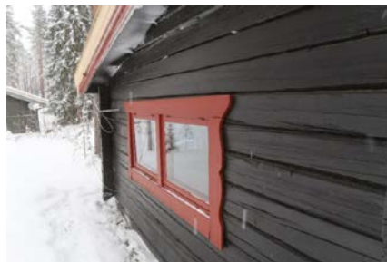
Bilde vise manglende beslag over og under vindu.
