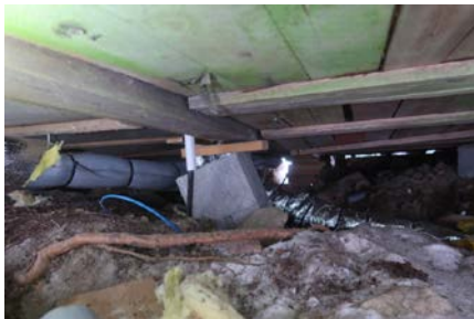
Bilde viser skjevhet i pilar under teknisk rom.
