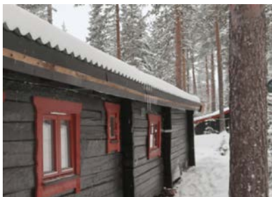
Ising på yttertak over teknisk rom.
