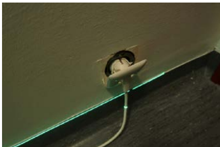
Bilde viser løs stikkontakt på teknisk rom.
