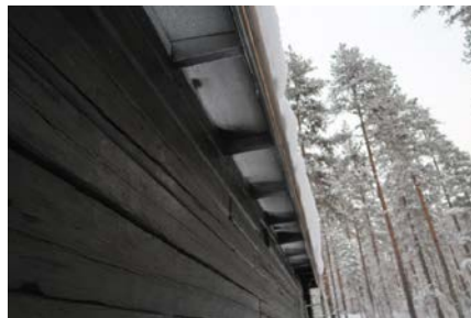
Bilde viser rim- og isdannelser i takutstikk.
