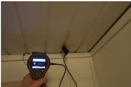
Bilde viser fuktskadet himling i teknisk rom. Ikke skadelig fukt på befaringsdagen.
