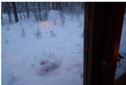
Bilde viser vindu på kjøkken med sprekk i ene glasset.
