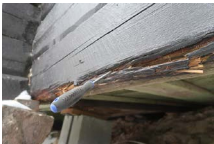
Bilde viser eksempel på råteskade i bunnstokk mot øst.
