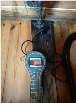
Fuktskade soveromsgulv i underetasje.
