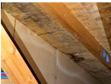
Misfarget undertak og fuktskjolde i undertak
