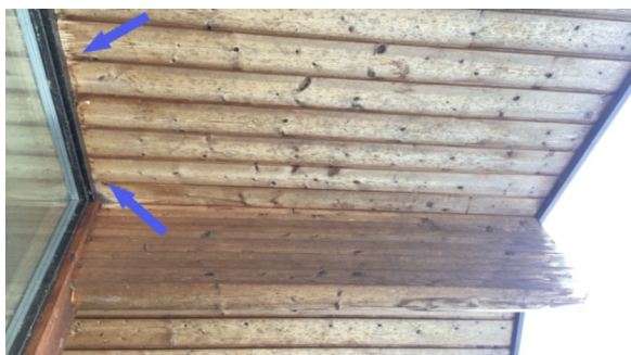
Misfarging og fuktmerker på bord utvendig.
