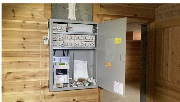
Sikringsskap på bod i kjeller.
