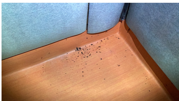
Fuktskader på plater.
