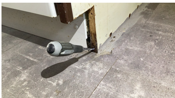
Fuktskade på innredning.
