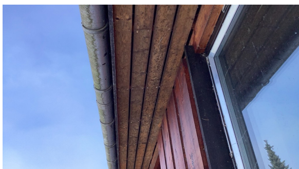
Misfarging på gesimskasse rundt om.
