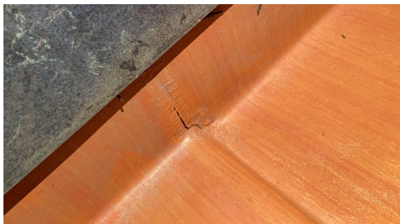
Hull i belegg i dusjsone.
