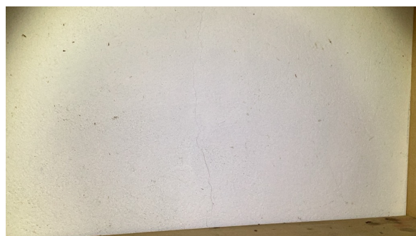
Sprekk i mur.
