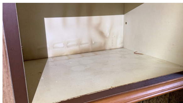
Misfarging i skap.
