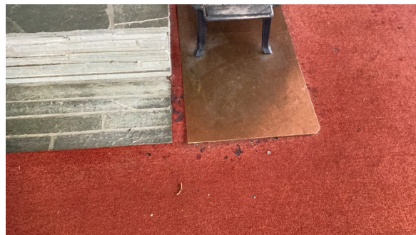
Ikke tilstrekkelig plate foran ildsted. Brennmerker på teppe.
