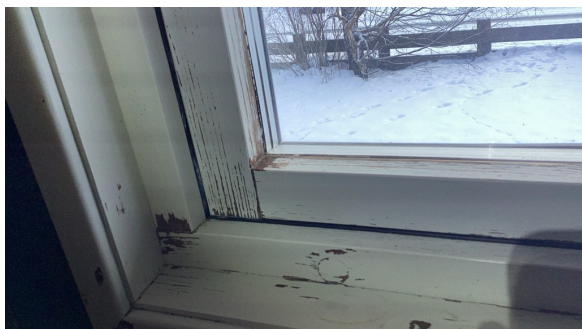
Kondensmerker i vinduer.
