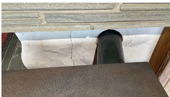
Sprekk i puss/pipe.
