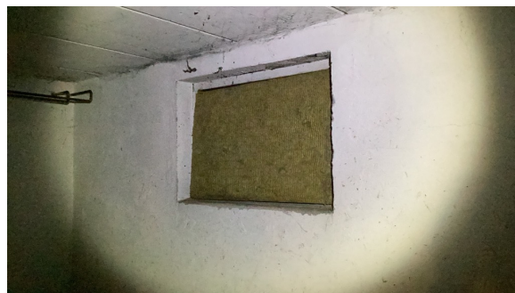
Mangler vindu på bod i kjeller.
