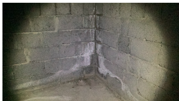
Kalkutslag i kjeller.
