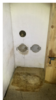
Feieluke og hull i pipe etter tidligere røykrør i kjeller.
