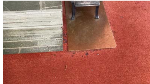
Ikke tilstrekkelig plate foran ildsted. Brennmerker på teppe.
