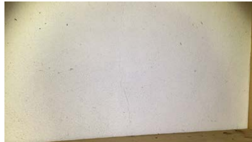
Sprekk i mur.
