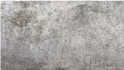
Sprekk i gulv i tilbygd del av 1. etasje.
