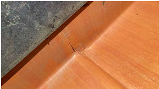
Hull i belegg i dusjsone.
