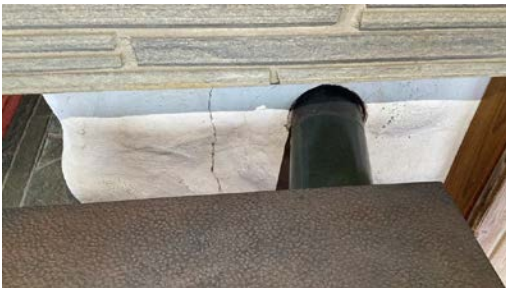
Sprekk i puss/pipe.
