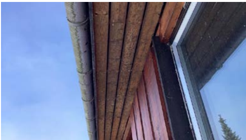
Misfarging på gesimskasse rundt om.
