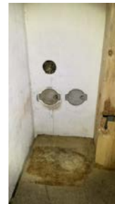
Feieluke og hull i pipe etter tidligere røykrør i kjeller.
