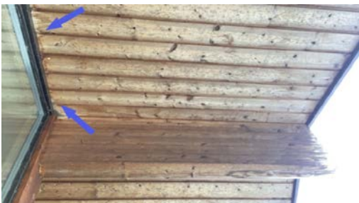
Misfarging og fuktmerker på bord utvendig.
