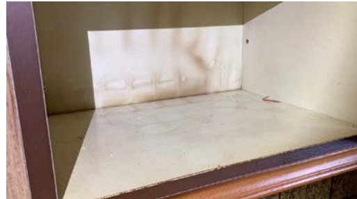
Misfarging i skap.
