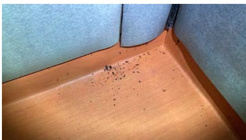
Fuktskader på plater.
