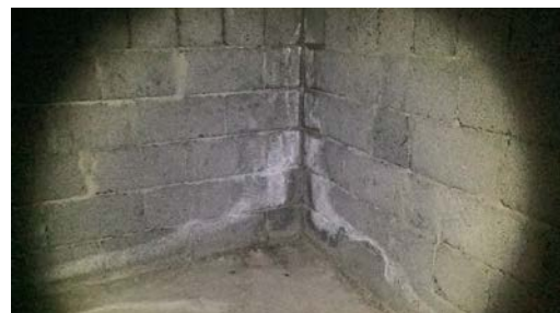
Kalkutslag i kjeller.
