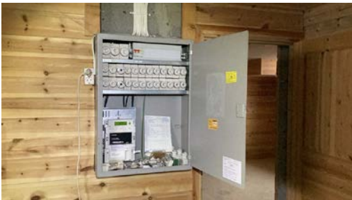
Sikringsskap på bod i kjeller.
