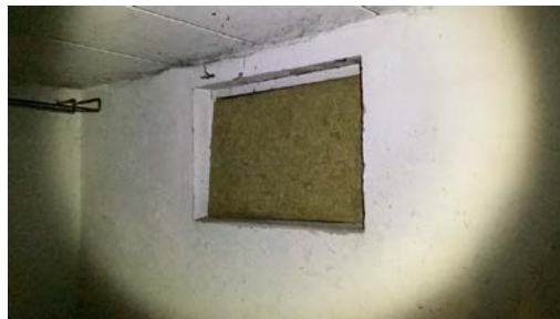
Mangler vindu på bod i kjeller.
