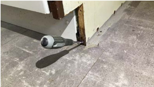
Fuktskade på innredning.
