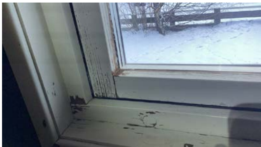
Kondensmerker i vinduer.
