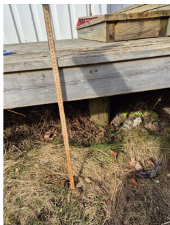
Mangler rekkverk på nederste plan.
