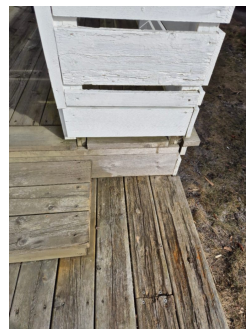
Råte i rekkverk og terrassebord.
