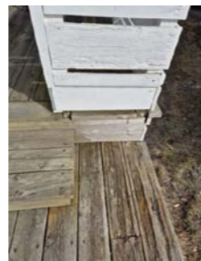
Råte i rekkverk og terrassebord.
