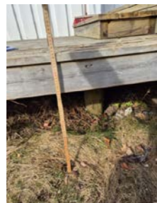
Mangler rekkverk på nederste plan.
