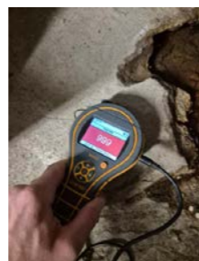
Indikert høye fuktverdier i gulv og vegger.
