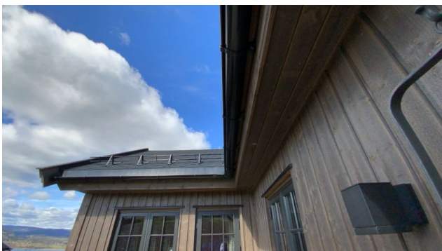
Synlige luftespalter i gesimskasse.
