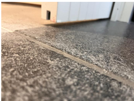
Fuktmerker på dør til bad
