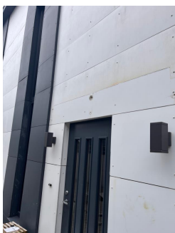
Skader på plater etter demontert skjermtak
