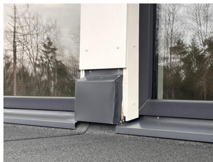
Oppkant under vindu er veldig liten
