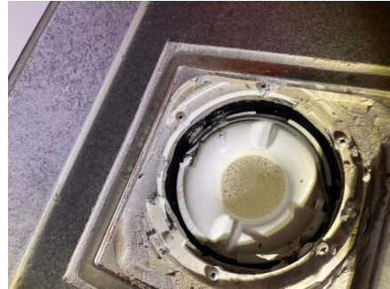
Synlig mansjett under klemring i sluket.
