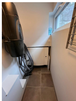
Rør fra radonbrønn under den lille flisen?
