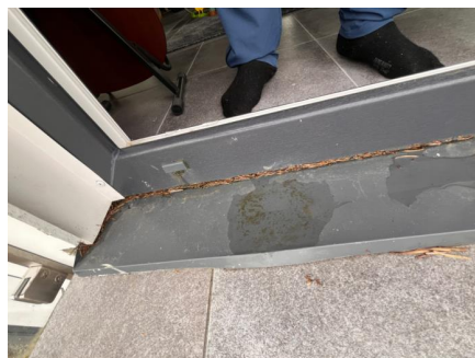
Liten oppkant under dør og skadet beslag
