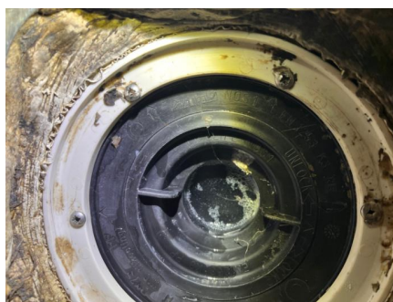
Mansjett er ikke lagt inn under klemring slik det ser ut.
