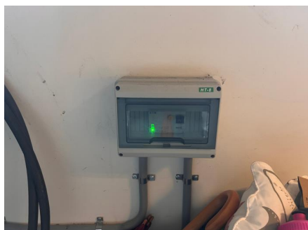
Sikring for bil lader plassert i garasje.
