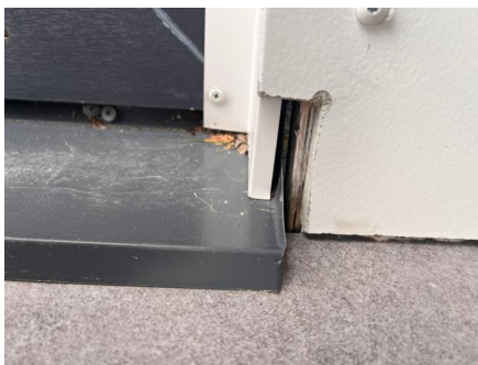
Dårlig tilpasset og plate er avsluttet helt ned mot terrasse.
