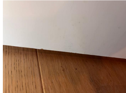
Fuktmerker på dør til toalett
