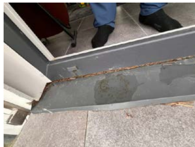
Liten oppkant under dør og skadet beslag
