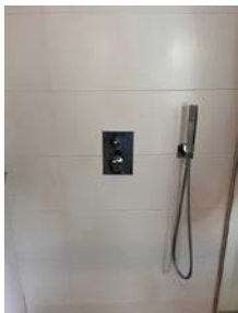
Innbygd blandebatteri, noe skjevt montert.
