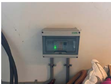
Sikring for bil lader plassert i garasje.
