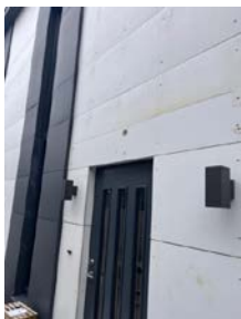
Skader på plater etter demontert skjermtak
