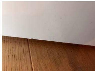
Fuktmerker på dør til toalett
