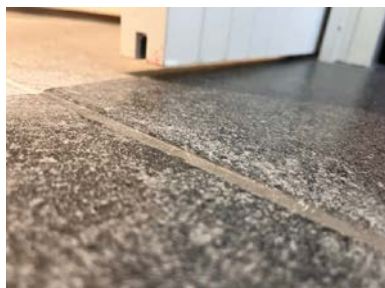
Fuktmerker på dør til bad
