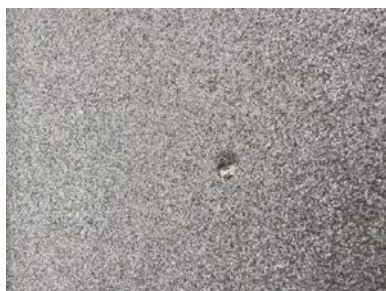
Det er en liten skade på pappen
