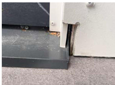
Dårlig tilpasset og plate er avsluttet helt ned mot terrasse.
