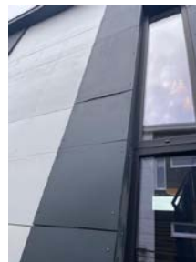
Ujevne overflater og spalter mellom plater.
