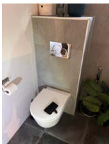
Veggmontert toalett og toalett dusj.
