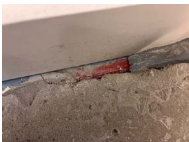
Hull på radonsperre.
