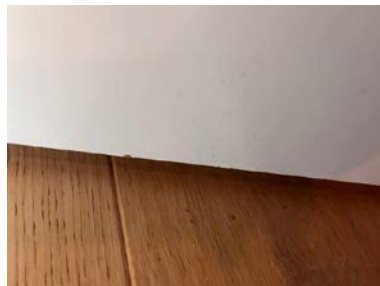
Fuktmerker på dør til toalett
