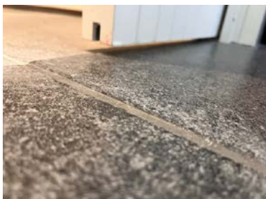
Fuktmerker på dør til bad
