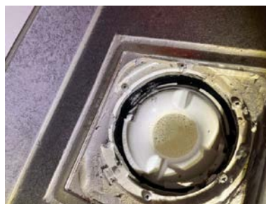
Synlig mansjett under klemring i sluket.
