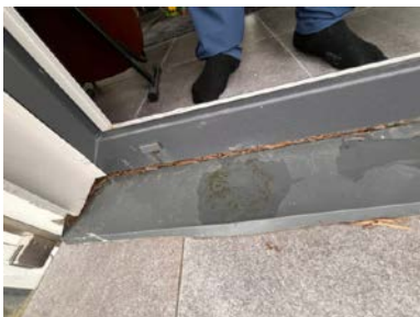
Liten oppkant under dør og skadet beslag
