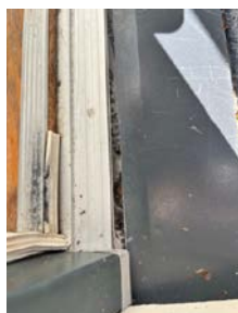
Løst beslag under hovedinngangsdør.
