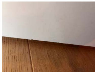
Fuktmerker på dør til toalett
