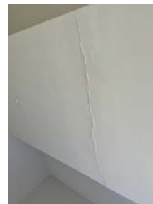
Sprekk i nedkasset himling på soverom.
