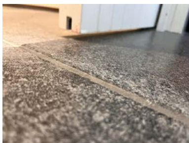
Fuktmerker på dør til bad
