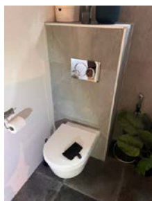
Veggmontert toalett og toalett dusj.
