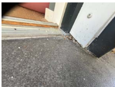
Liten oppkant under dør og løsnet fuge
