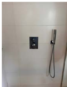
Innbygd blande batteri, noe skjevt montert.
