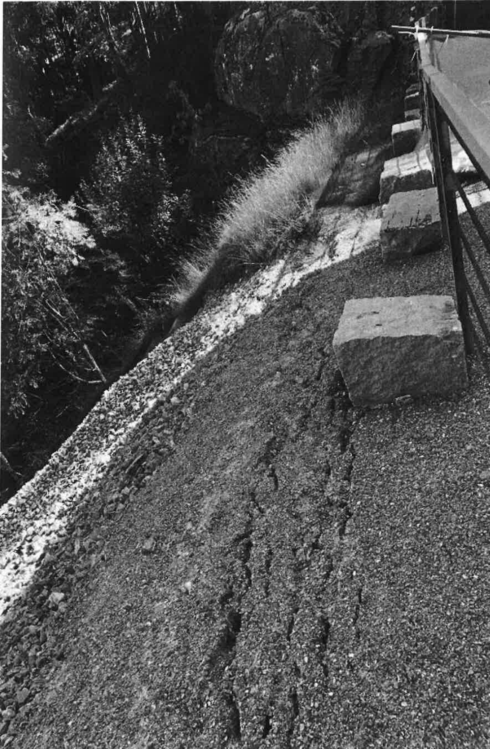
Figur 3-3. Sprekker på toppen av skråningen parallelt til kanten. Datert 26. juli 2018.
