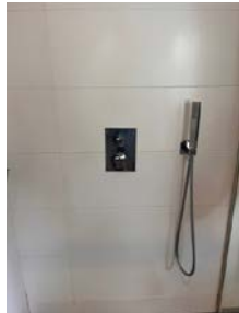
Innbygd blandebatteri, noe skjevt montert.
