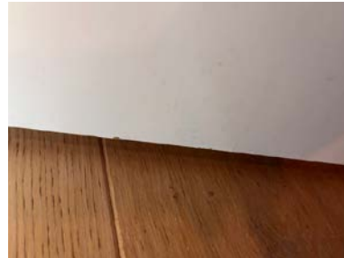
Fuktmerker på dør til toalett
