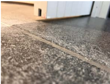
Fuktmerker på dør til bad
