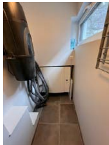
Rør fra radonbrønn under den lille flisen?
