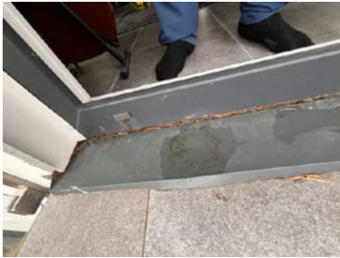
Liten oppkant under dør og skadet beslag
