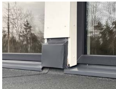
Oppkant under vindu er veldig liten
