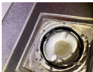
Synlig mansjett under klemring i sluket.
