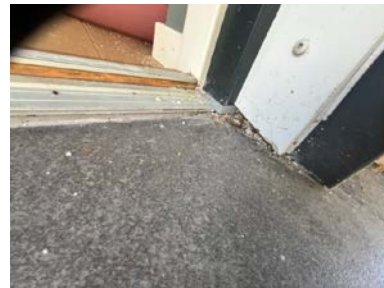
Liten oppkant under dør og løsnet fuge
