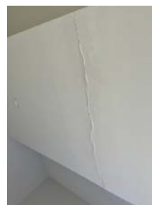
Sprekk i nedkasset himling på soverom.
