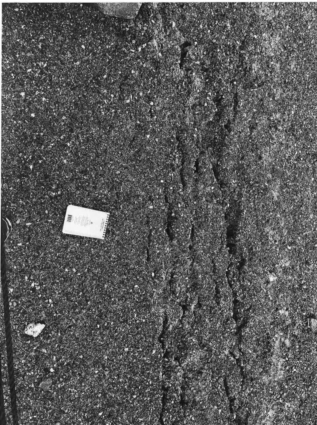
Figur 3-4. Sprekker på toppen av skråningen. Lengde av gul notebok er 15 cm.
