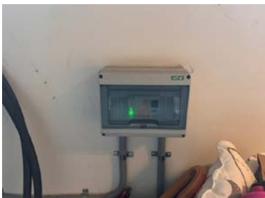
Sikring for bil lader plassert i garasje.
