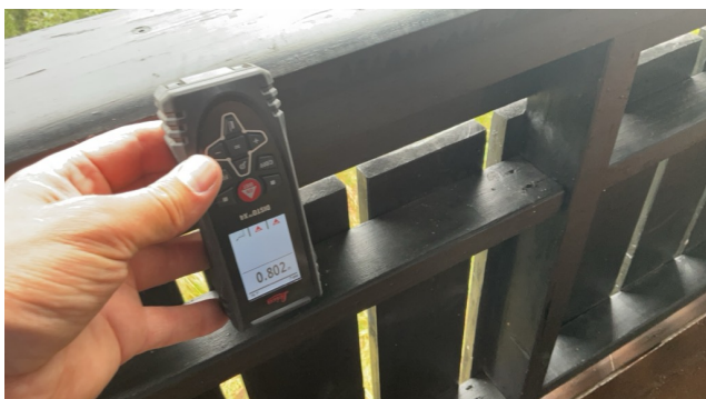
Rekkverkshøyde under dagens krav
