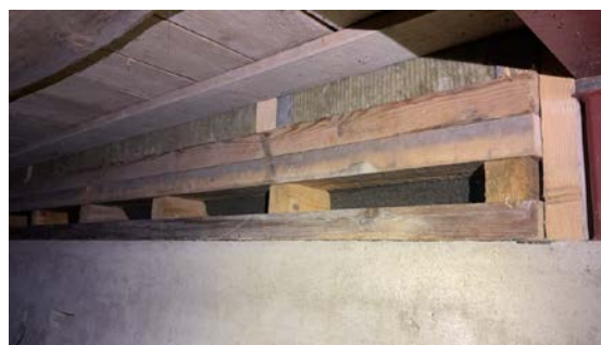
Åpen konstruksjon mot vegg, fare for åpning/inngang mot mus/skadedyr og anbefales tiltak. (ukjent tilstand i lukket konstruksjon)
