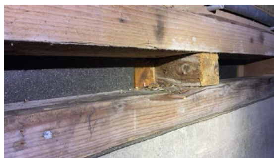
Bjelker fra terrasse er lagt ann gjennom bunnsvill yttervegg, synlig fuktvandring fra terrasse og fare for fukt og skadeutvikling på konstruksjon der nærmere ettersyn og tiltak bør vurderes
