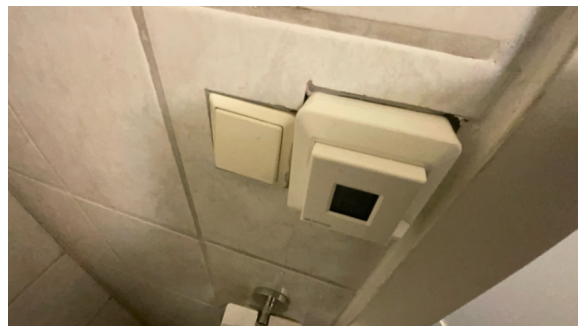
Ettermonterte fliser, ikke fagmessig utført.
