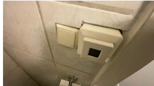
Ettermonterte fliser, ikke fagmessig utført.
