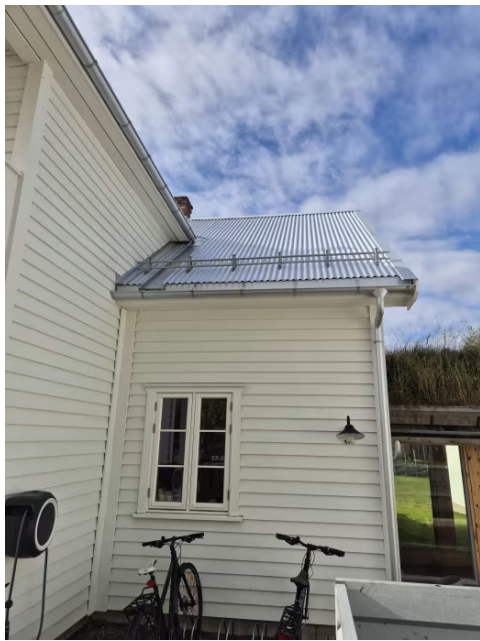
Viser etablerte snøfanger på tekking.
