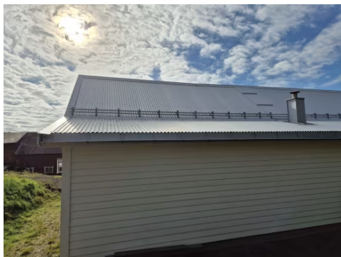
Viser etablerte snøfanger på tekking.
