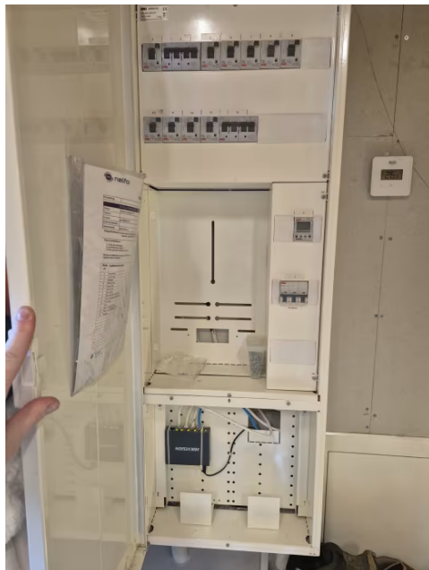
Viser sikringskap med automatsikringer, sikringskap for tilbygget del plassert i garasje.
