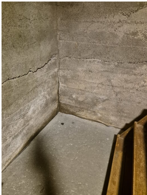
Viser fuktmerker grunnmur i kjeller (ved trapp).
