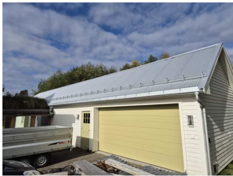
Viser etablerte snøfanger på tekking.
