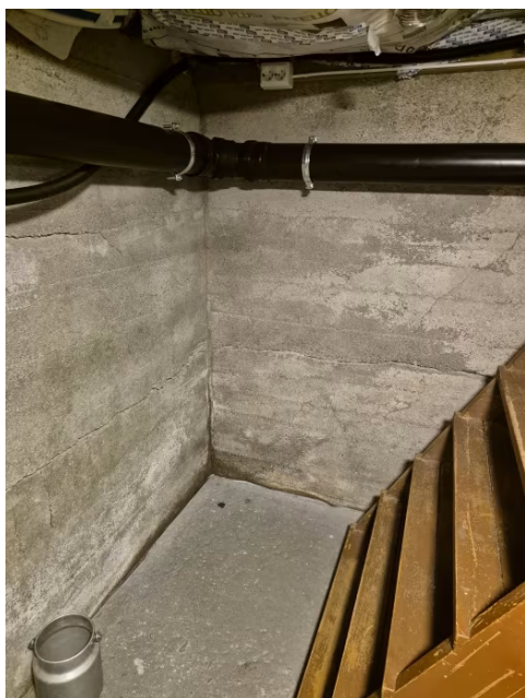
Viser fuktmerker grunnmur i kjeller (ved trapp).
