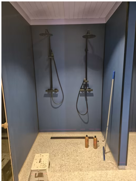
Viser dusjnise med veggehengte termostattbatterier og dusjgarnityr.
