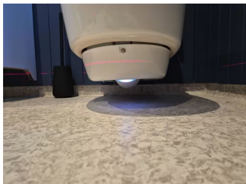
Viser vegghengt toalett med innebygget systerne, ikke etablert dreinsåpning som synliggjør eventuelle lekkasjer fra innebygget systerne.
