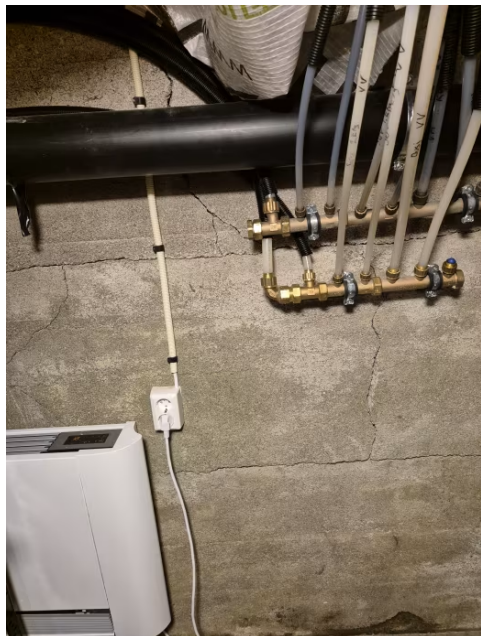
Viser skader/sprekker i grunnmur med kjeller.
