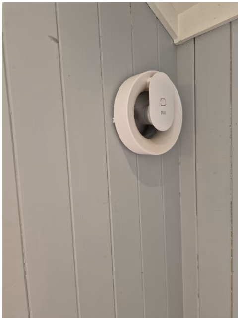
Viser ventilering med mekanisk vifte, avtrekk ført ut av vegg mot fri.
