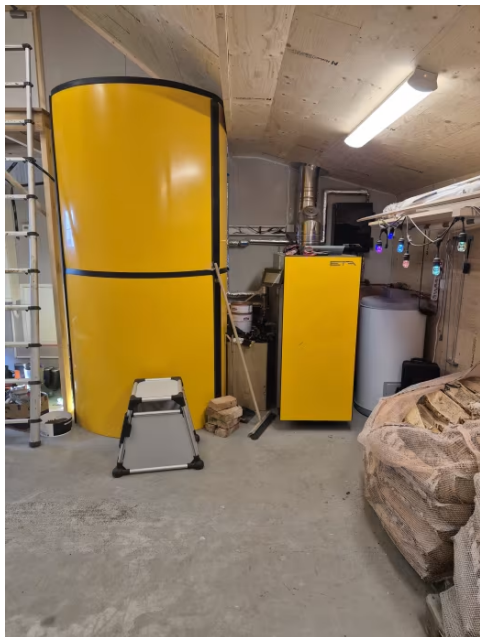
Viser plassering av varmesentral i garasje.
