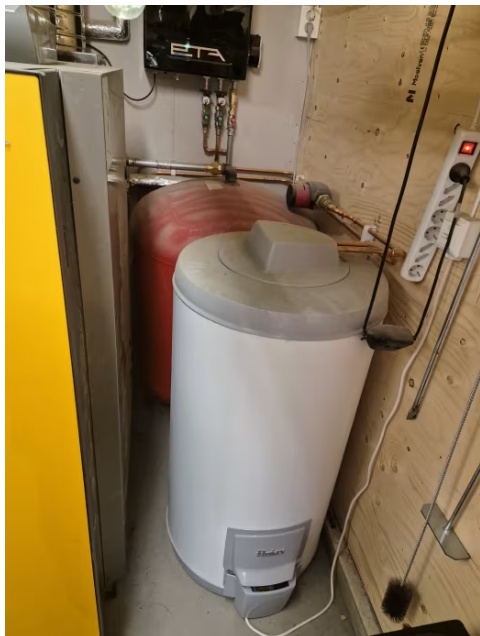
Viser plassering av varmtvannsbereder i garasje.
