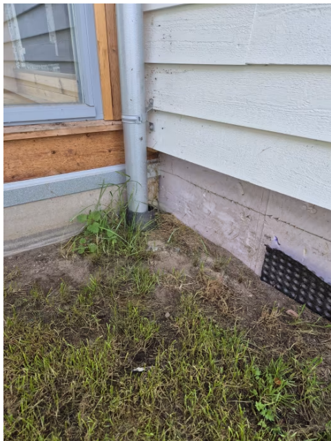
Viser manglende grunnmursplast.
