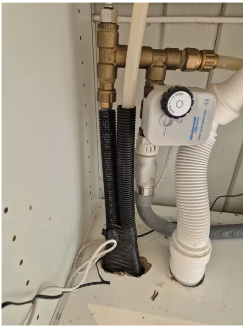
Viser manglende klamring av vannrør og manglende tettehylse mellom vannrør og varerør (rør i rørsystem).
