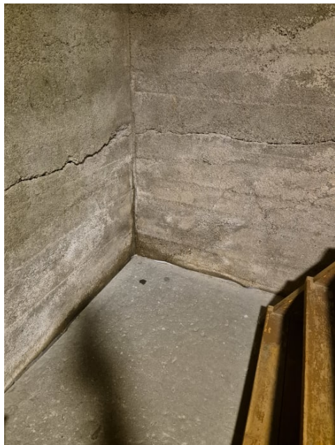
Viser skader/sprekker i grunnmur med kjeller.
