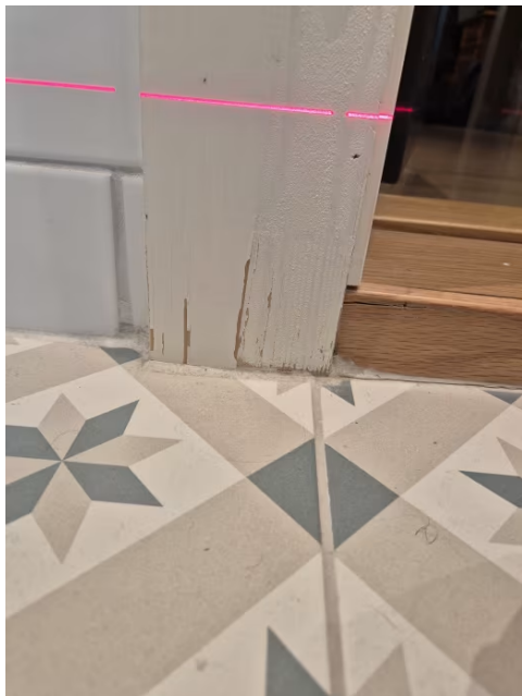
Viser dør er plassert i våtsone, dør med karmen og listverk vil ikke tåle belastningen av fritt vann.
