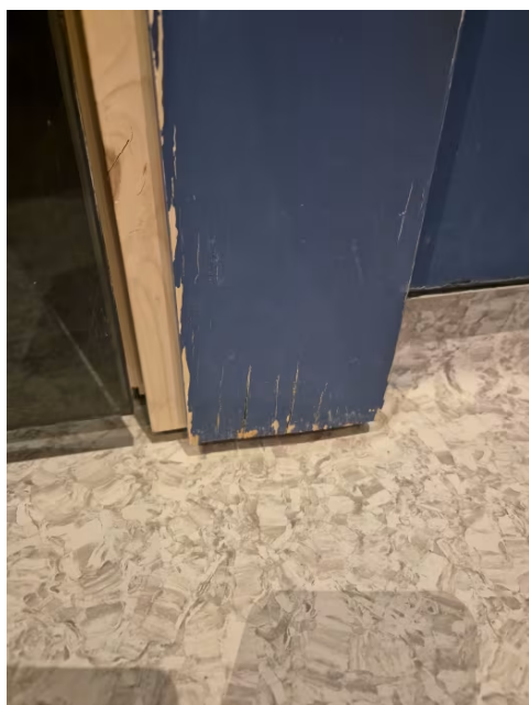
Viser dør er plassert i våtzone, dør med karmen og listverk vil ikke tåle belastningen av fritt vann.
