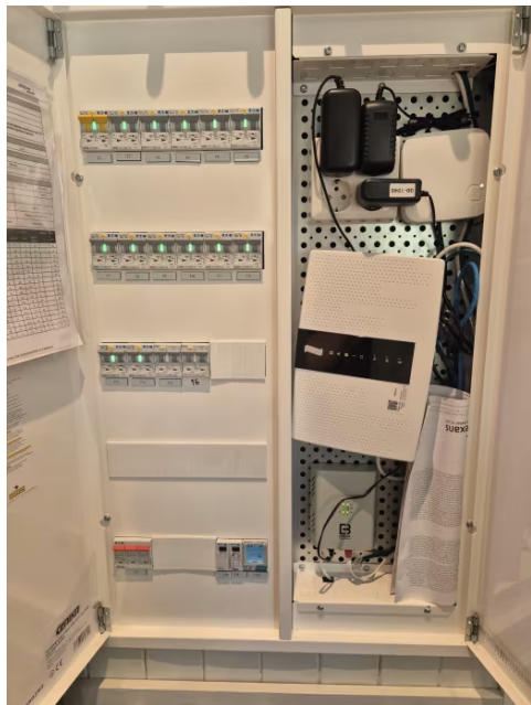
Viser sikringskapp med automatsikringer, sikringskapp for opprinnelig del plassert i entre.
