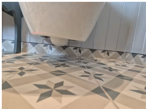
Viser vegghengt toalett med innebygget sisterner, ikke etablert drengåpning som synliggjør eventuelle lekkasjer fra innebygde sisterner
