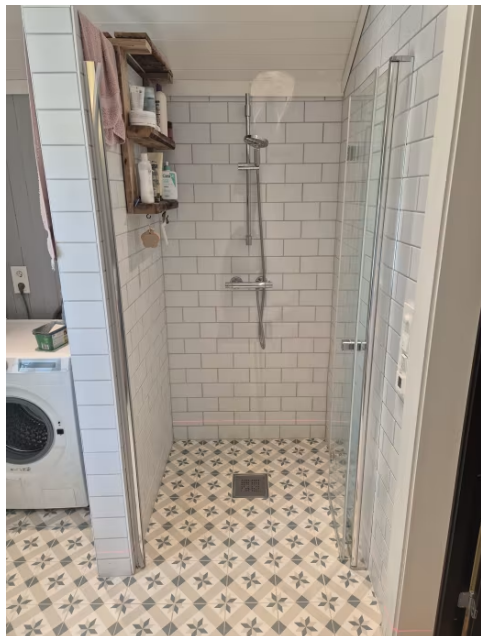
Viser dusjnise med leddet dusjdør, veggehengt termostatbatteri og dusjgarnityr.
