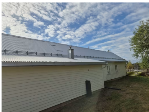
Viser etablerte snøfanger på tekking.
