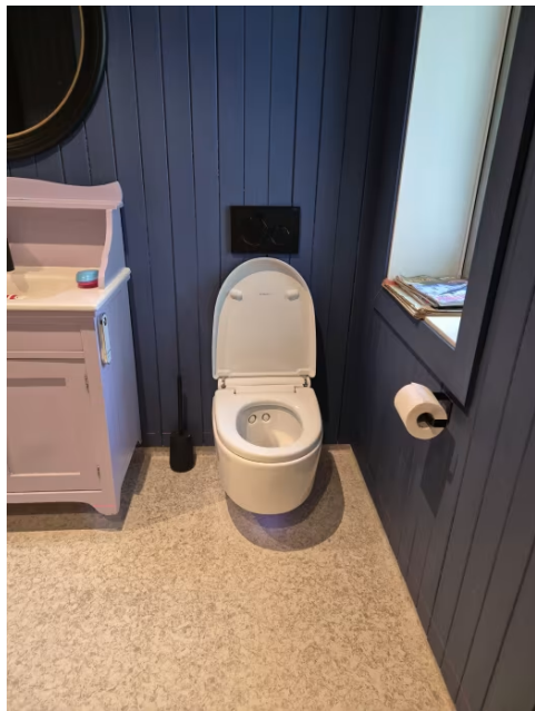
Viser vegghengt toalett med innebygget systerne, toalett med spylefunksjon (Geberit Aquaclean)
