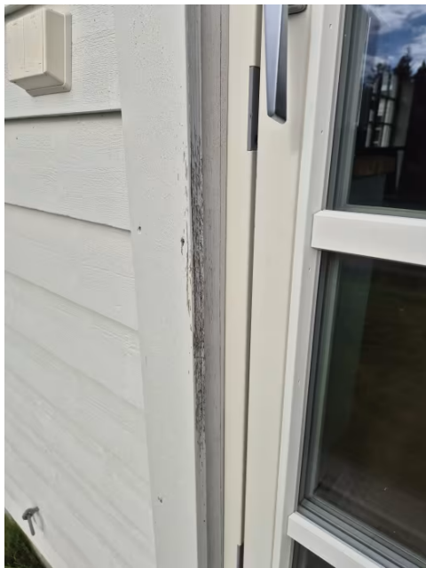
Viser slitasje/skader på utforinger og lister.
