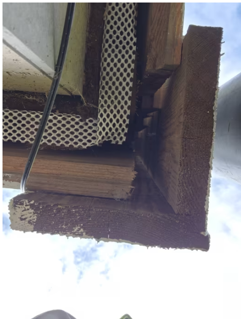
Viser eksempel av manglende musetetting, åpning mellom bånd og kledning er stor.
