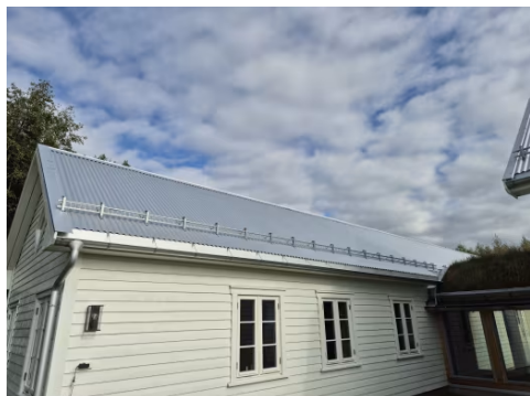
Viser etablerte snøfanger på tekking.
