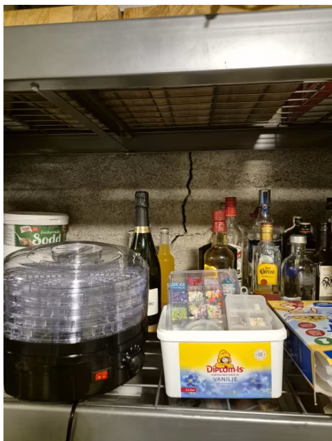
Viser skader/sprekker i grunnmur med kjeller.
