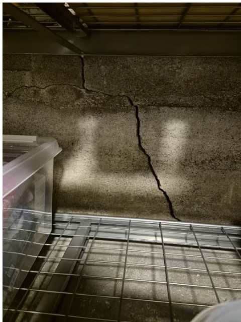
Viser skader/sprekker i grunnmur med kjeller.
