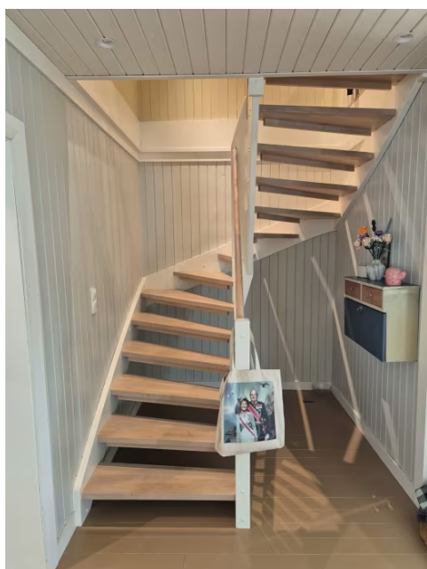
Viser trapp med manglende håndløper langs vegg.
