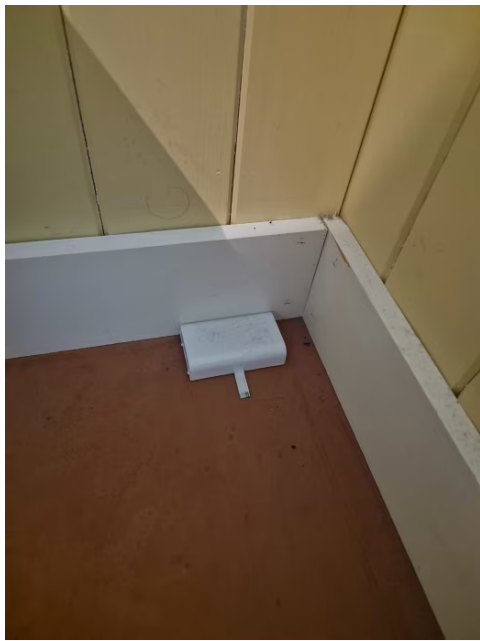
Viser etablert føler tilknyttet vannstoppeventil.
