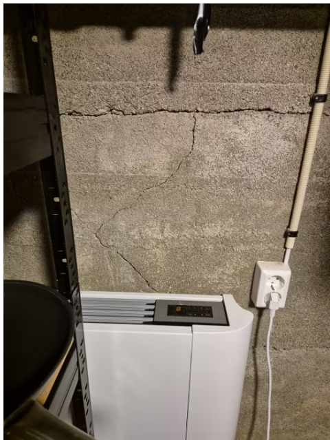
Viser skader/sprekker i grunnmur med kjeller.
