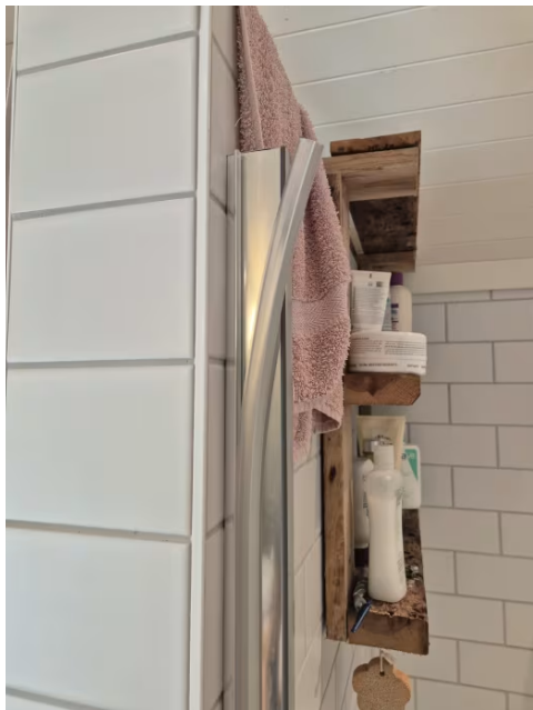
Viser løse lister tilknyttet leddet dusjdør.
