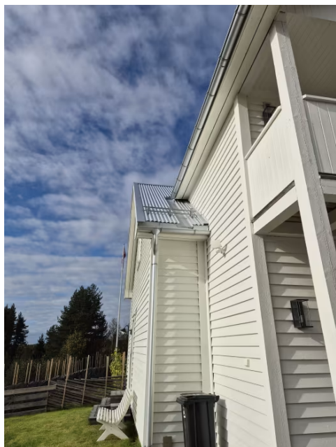
Viser etablerte snøfanger på tekking.
