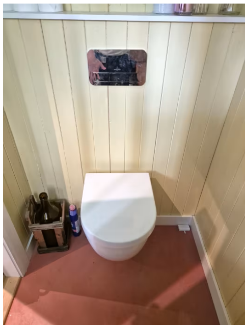
Viser vegghengt toalett med innebygget systerne, ikke etablert dremsåpning som synliggjør eventuelle lekkasjer fra innebygd systerne
