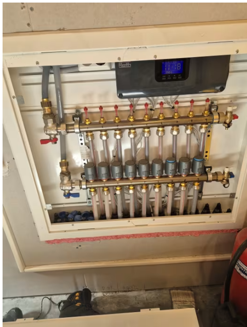
Viser innvendig i gulvvarmeskap med avstengningskraner for tur/retur, fordeler, avtapping med lufteskruer, master og aktuatorer tilknyttet romtermostat.
