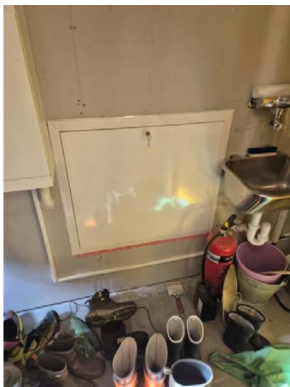
Viser plassering av gulvvarmeskap i garasje.
