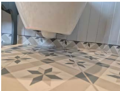
Viser vegghengt toalett med innebygget sisterner, ikke etablert drengs pning som synliggj r eventuelle lekkasjer fra innebygd sisterner
