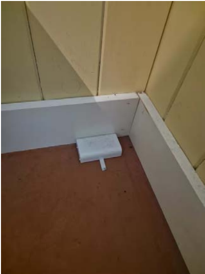
Viser etablert føler tilknyttet vannstoppeventil.
