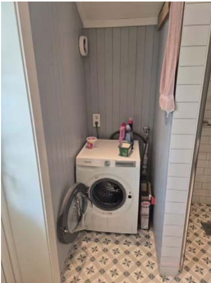
Viser plass og opplegg for vaskemaskin.
