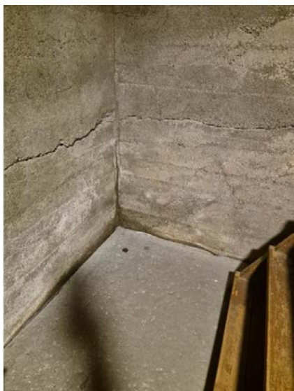
Viser fuktmerker grunnmur i kjeller (ved trapp).
