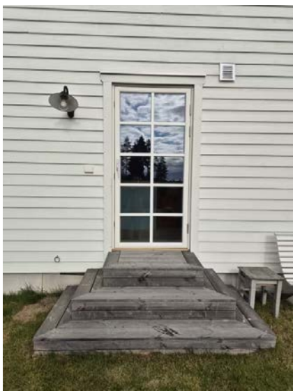
Viser terrassedør med slitasje/skader på utforinger og lister.
