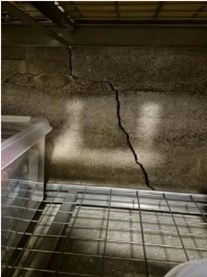
Viser skader/sprekker i grunnmur med kjeller.
