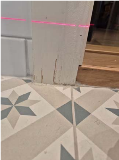
Viser dør er plassert i våtsone, dør med karmen og listverk vil ikke tåle belastningen av fritt vann.
