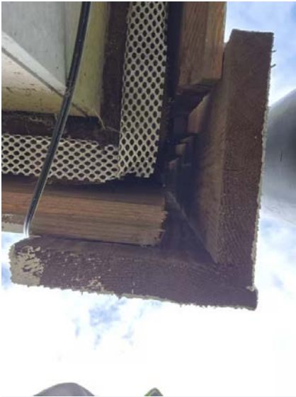
Viser eksempel av manglende musetetting, åpning mellom bånd og kledning er stor.
