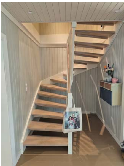
Viser trapp med manglende håndløper langs vegg.
