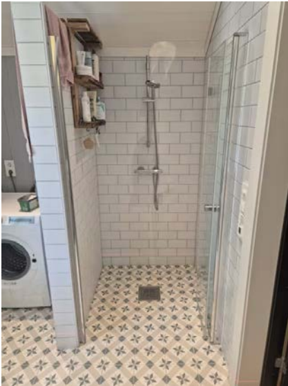
Viser dusjnise med leddet dusjdør, veggehengt termostattbatteri og dusjgarnityr.
