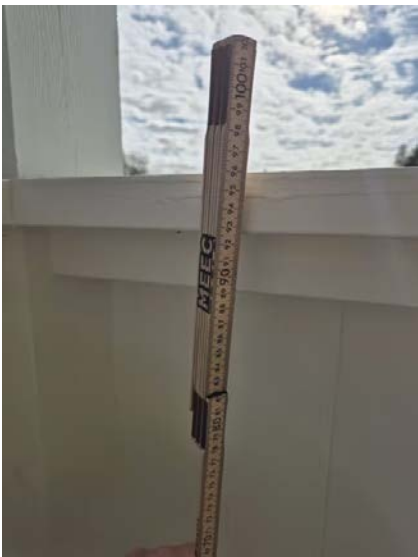
Viser målt rekkverkshøyde, rekkverket blir målt til 96 cm. og er lavere enn forskriftskravet på 100 cm.
