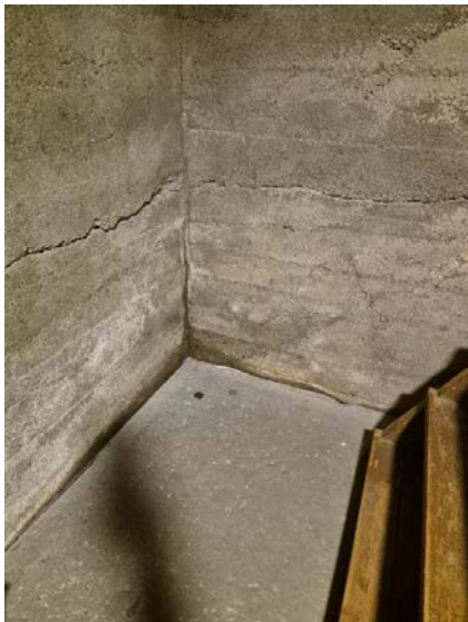
Viser skader/sprekker i grunnmur med kjeller.
