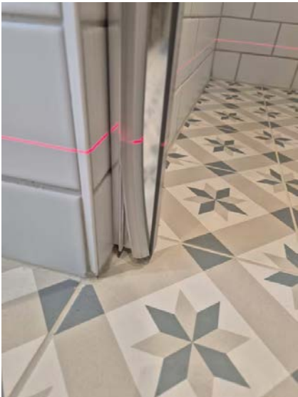
Viser løse lister tilknyttet leddet dusjdør.
