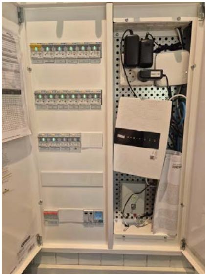
Viser sikringskap med automatsikringer, sikringskap for opprinnelig del plassert i entre.
