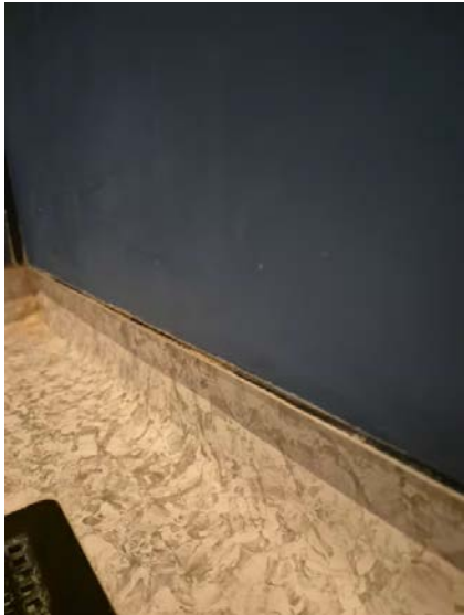
Viser svellinger, misfarging og skader i overflater i dusjsone, dette kan settes i sammenheng med fuktskade på baderomsplater.
