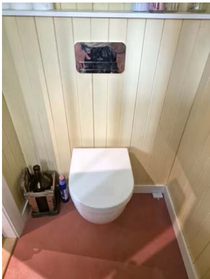
Viser vegghengt toalett med innebygget systerne, ikke etablert dremsåpning som synliggjør eventuelle lekkasjer fra innebygget systerne
