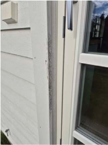
Viser slitasje/skader på utforinger og lister.
