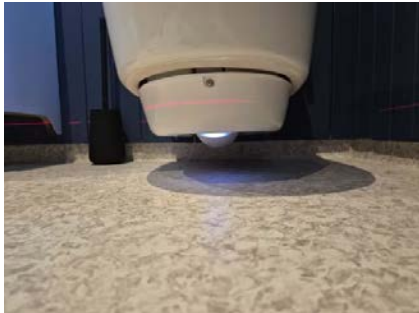
Viser vegghengt toalett med innebygget sisterner, ikke etablert dreinsåpning som synliggjør eventuelle lekkasjer fra innebygget sisterner.
