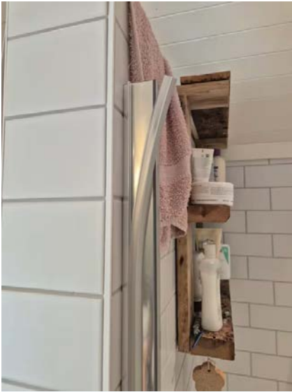
Viser løse lister tilknyttet leddet dusjdør.
