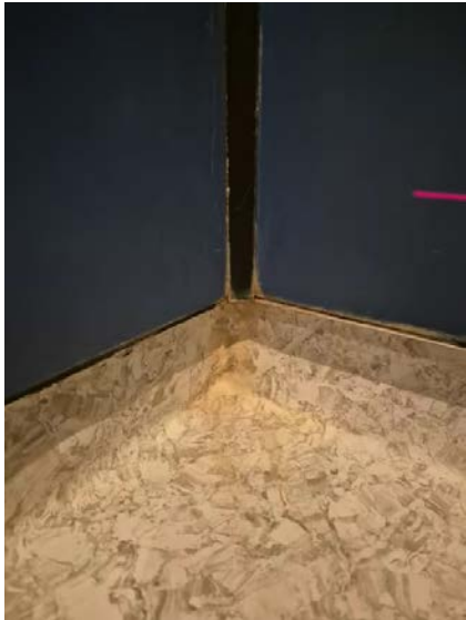
Viser svellinger, misfarging og skader i overflater i dusjsone, dette kan settes i sammenheng med fuktskade på baderomsplater.
