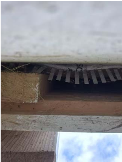
Viser eksempel av manglende musetetting, åpning mellom bånd og kledning er stor.
