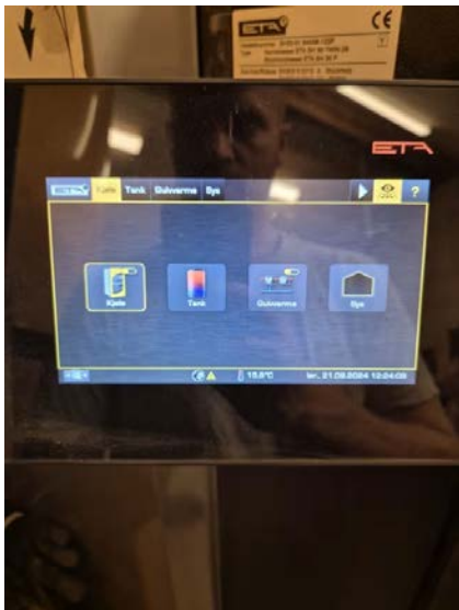
Viser kontrollpanel varmesentral, ingen aktive alarmer.
