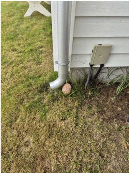
Et nedløp er ikke tilknyttet avløpsanlegg i grunn, her er det etablert utkast med godt terrengfall.
