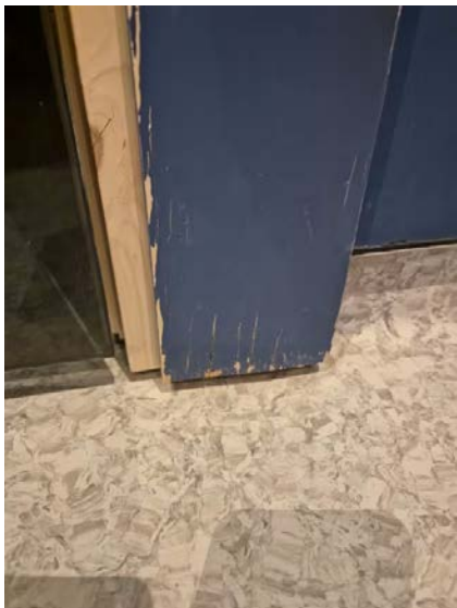
Viser dør er plassert i våtsone, dør med karm og listverk vil ikke tåle belastningen av fritt vann.
