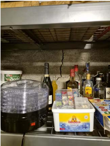
Viser skader/sprekker i grunnmur med kjeller.
