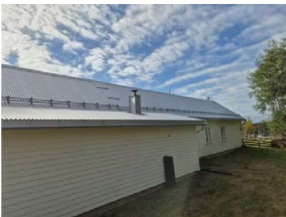
Viser etablerte snøfanger på tekking.
