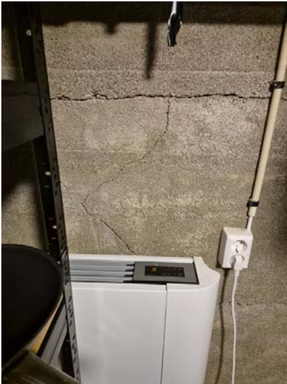
Viser skader/sprekker i grunnmur med kjeller.
