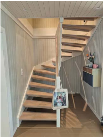
Viser trapp med manglende håndløper langs vegg.
