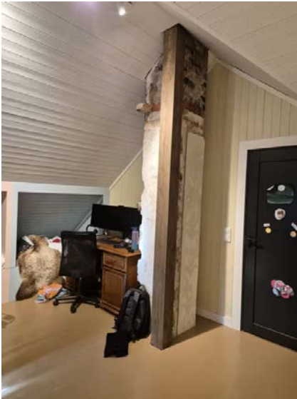
Viser pipe 2. etasje.
