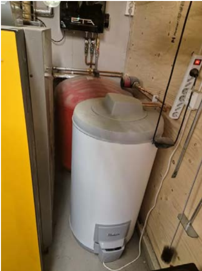
Viser plassering av varmtvannsbereder i garasje.
