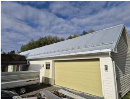
Viser etablerte snøfanger på tekking.
