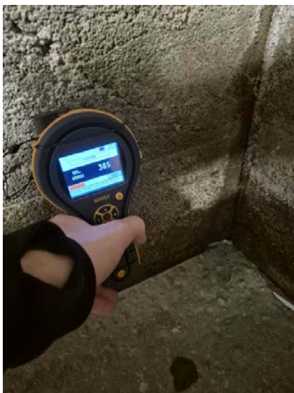
Viser fuktmåling, måling viser indikasjoner på fukt i nedre del av grunnmur.
