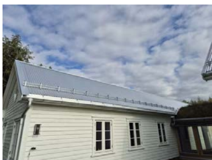
Viser etablerte snøfanger på tekking.
