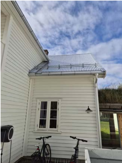
Viser etablerte snøfanger på tekking.
