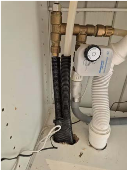
Viser manglende klamring av vannrør og manglende tettehylse mellom vannrør og varerør (rør i rørsystem).
