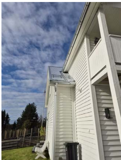
Viser etablerte snøfanger på tekking.
