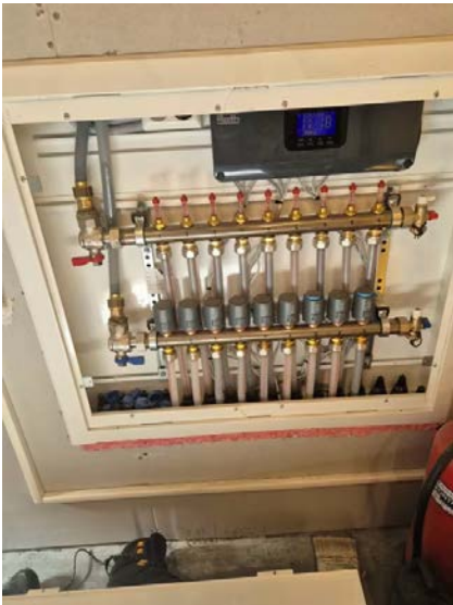
Viser innvendig i gulvvarmeskap med avstengningskraner for tur/retur, fordeler, avtapping med lufteskruer, master og aktuatorer tilknyttet romtermostat.
