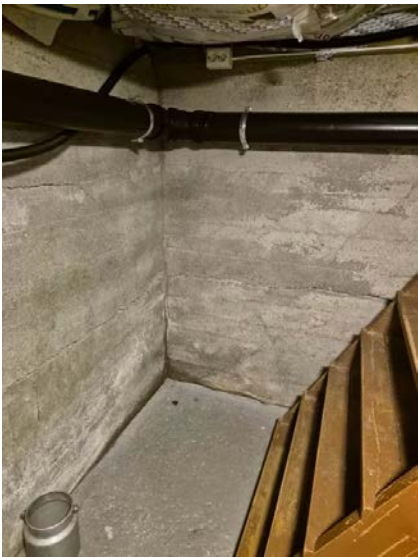
Viser fuktmerker grunnmur i kjeller (ved trapp).
