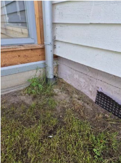
Viser manglende grunnmursplast.
