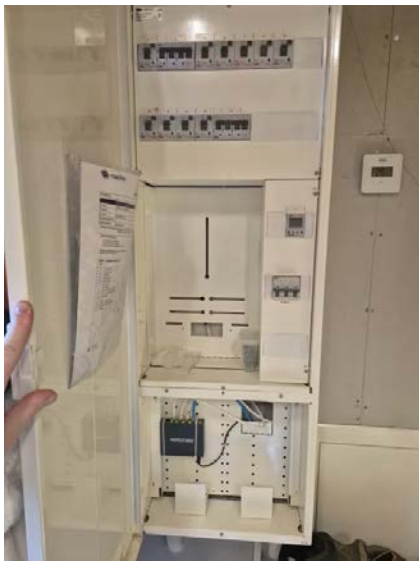
Viser sikringsskap med automatsikringer, sikringsskap for tilbygget del plassert i garasje.
