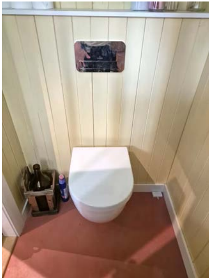
Viser vegghengt toalett med innebygget systerne, ikke etablert dremsåpning som synliggjør eventuelle lekkasjer fra innebygget systerne
