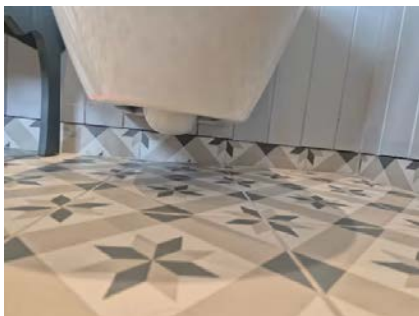
Viser vegghengt toalett med innebygget systerne, ikke etablert drengåpning som synliggjør eventuelle lekkasjer fra innebygd systerne
