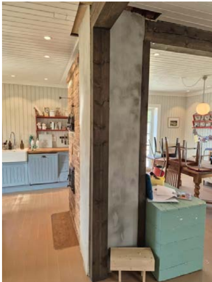
Viser pipe 1. etasje.
