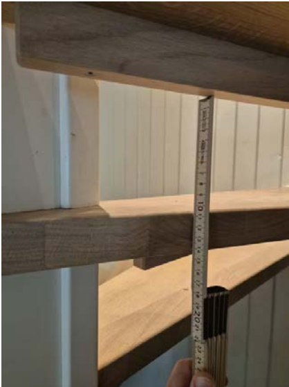
Viser åoning mellom opptrinn, målt åpning er over 10 cm (10,5 cm).
