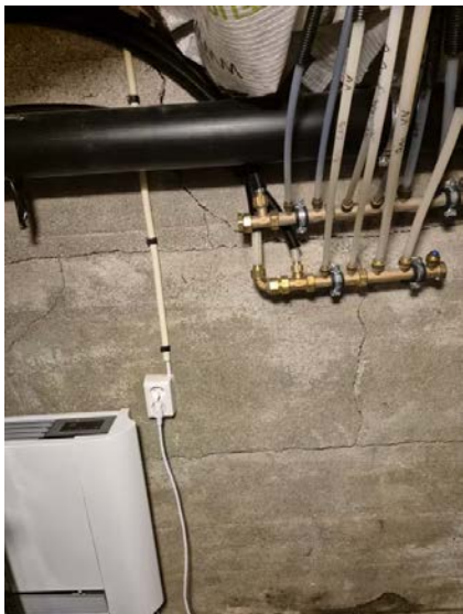
Viser skader/sprekker i grunnmur med kjeller.
