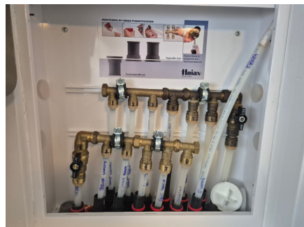
Rørskap i kjellerbod.
