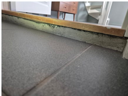
Ingen oppkant av membran ved terskel.
