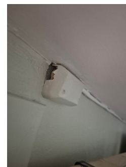
Skade på eldre koblingsboks i kjeller.
