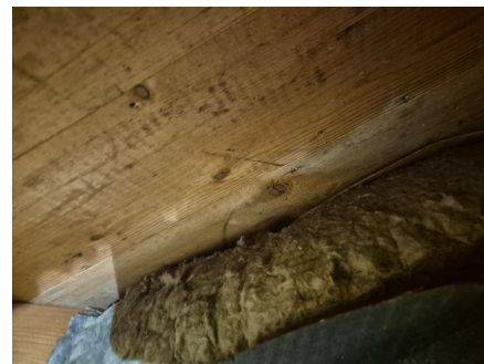
Rafteappen er presset opp mot undertaket.
