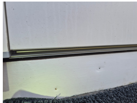
Mangler beslag under dør.
