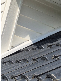
Råte i nederste kledningsbord på ark.
