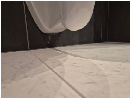
Mangler dreusspalte under toalett.
