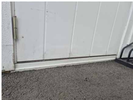
Fuktskjolder i bunn av garasjedør.
