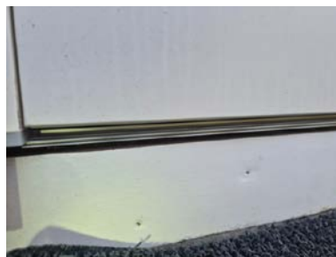
Mangler beslag under dør.
