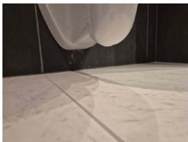
Mangler drengspalte under toalett.
