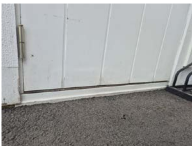
Fuktskjolder i bunn av garasjedør.
