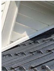
Råte i nederste kledningsbord på ark.
