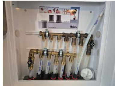
Rørskap i kjellerbod.
