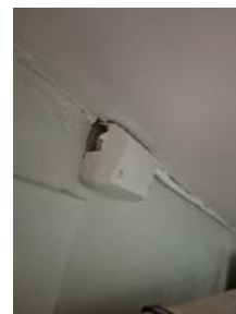
Skade på eldre koblingsboks i kjeller.
