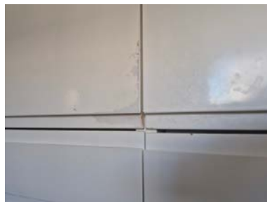
Slitasje på front til kjøl/fryseskap.
