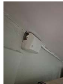
Skade på eldre koblingsboks i kjeller.
