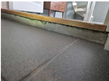
Ingen oppkant av membran ved terskel.
