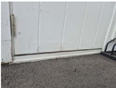
Fuktskjolder i bunn av garasjedør.
