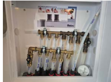
Rørskap i kjellerbod.
