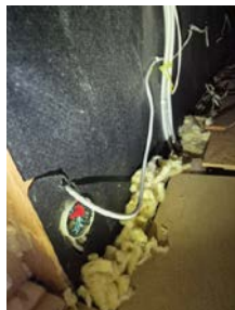
Ledninger i kneloft som ikke er tilstrekkelig festet.
