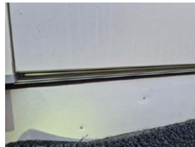
Mangler beslag under dør.
