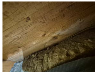
Rafteappen er presset opp mot undertaket.
