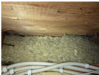
Liten luftespalte over takkonstruksjon.
