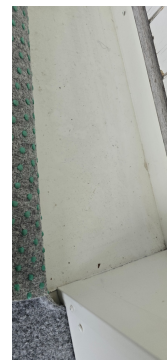
Beslag på gulv mellom terrasse og dør
