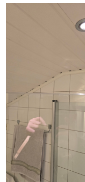
Himling skråtak i våtsone over dusj
