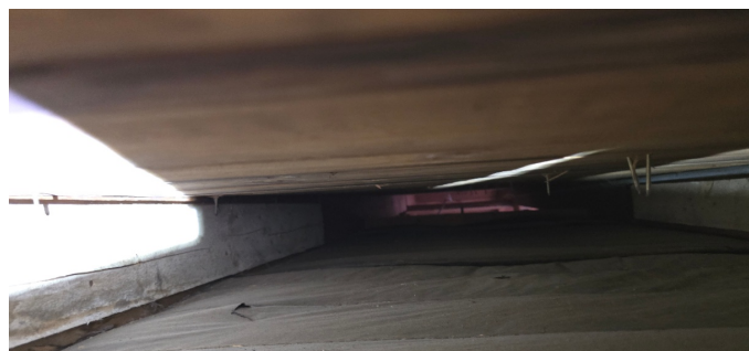
Ingen synlig isolering i skråtak
