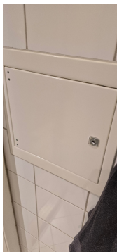
Mangler nøkkel/tilgang til fordeler skap
