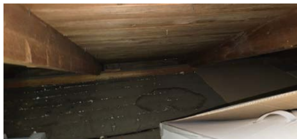
Kryp kott , fukt merker på gulv , begrenset lufting
