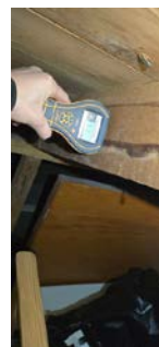
Normale fukt verdier på befaring
