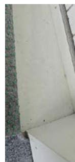
Beslag på gulv mellom terrasse og dør
