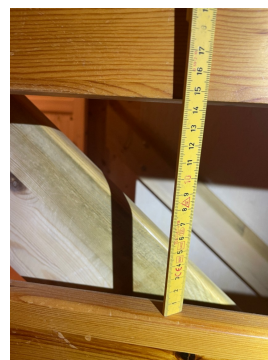
14 cm avstand mellom spiler i rekkverk
