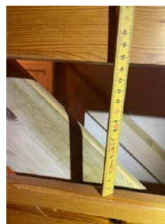
14 cm avstand mellom spiler i rekkverk
