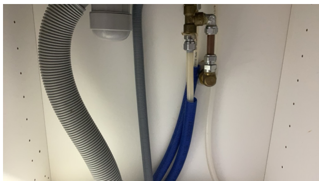
Manglende tettemuffe overgang vannrør og varerør
