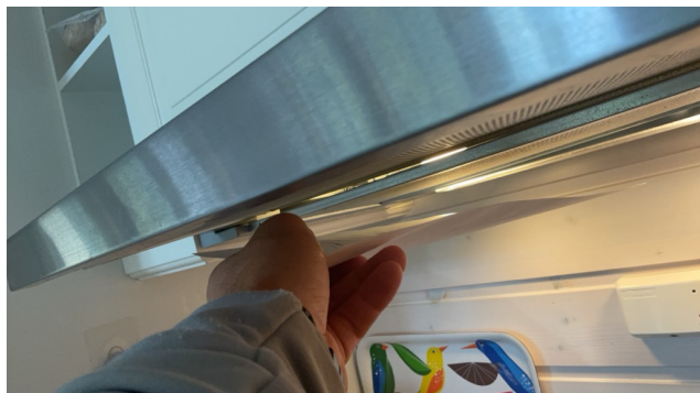
Begrenset effekt av ventilator funksjonstestet ved bruk av papirark
