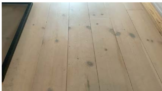
Riper og slitasje på gulvoverflate stedvis
