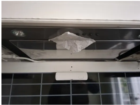
Avtrekkseffekten er testet med papir.
