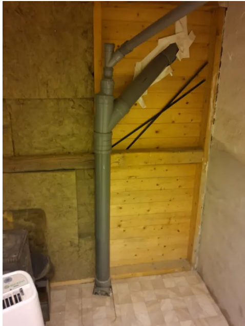
Avløpsrør av plast i kjeller.
