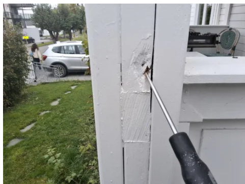
Det registreres stedvise råteskader.
