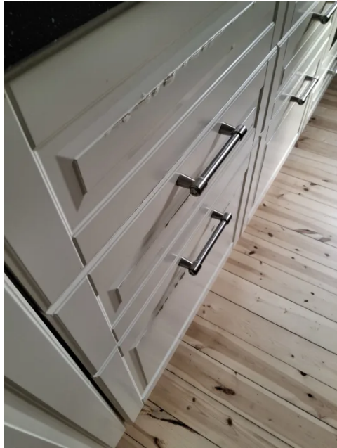
Det registreres folieslipp på enkelte fronter.
