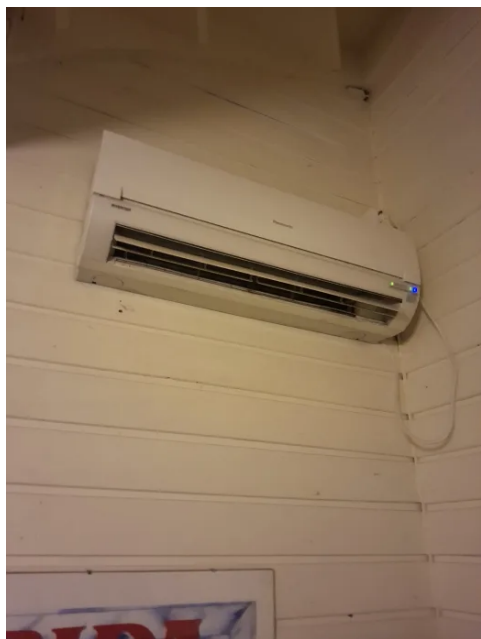
Eldre varmepumpe i trappegang.
