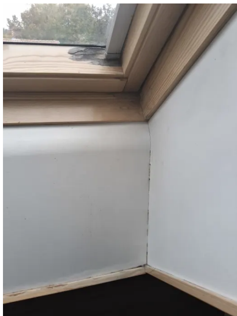
Fuktmerker i karm og foring til takvindu.
