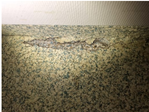
Det er skader i gulvoverflate.
