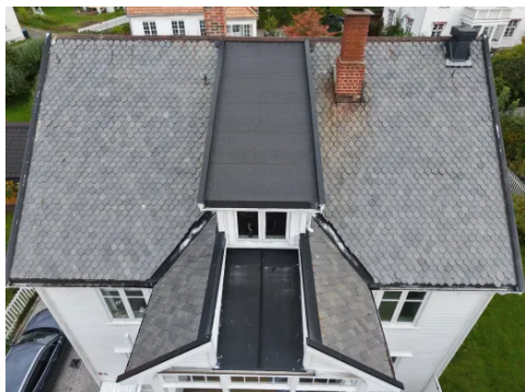
Det er ikke etablert snøfanger på taket.
