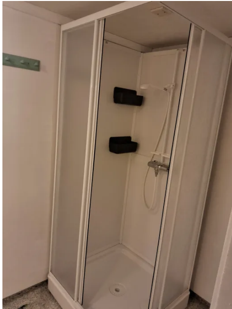
Det er montert dusjkabinett på badet.
