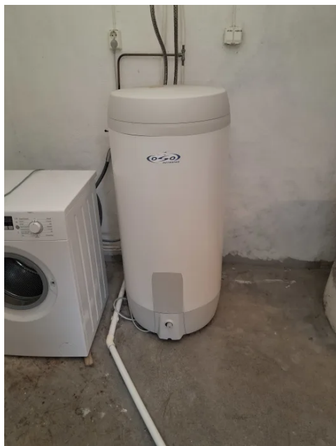
Varmtvannsbereder er plassert i vaskekjeller.
