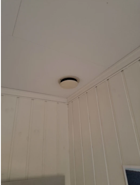
Rommet har naturlig avtrekk.
