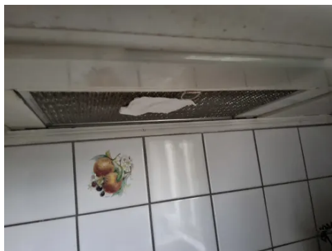
Avtrekkseffekt er testet med papir.
