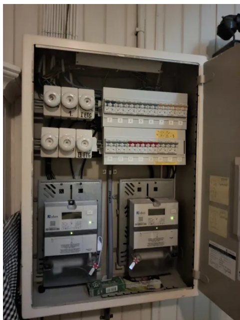
Sikringsskap er plassert i trappegang.
