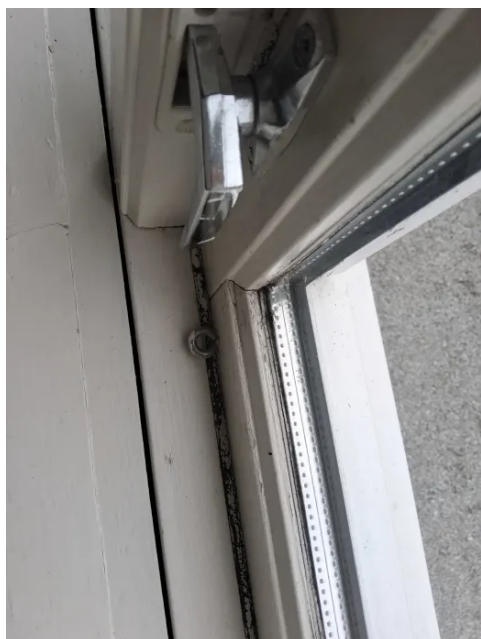
Tegn etter kondens er registrert på enkelte vinduer.
