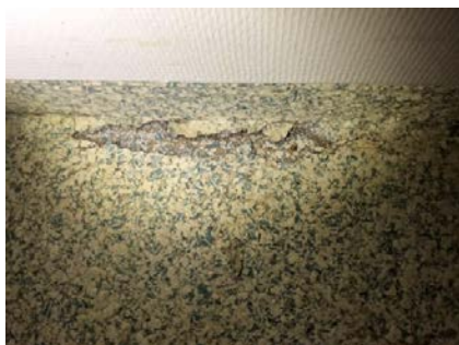
Det er skader i gulvoverflate.
