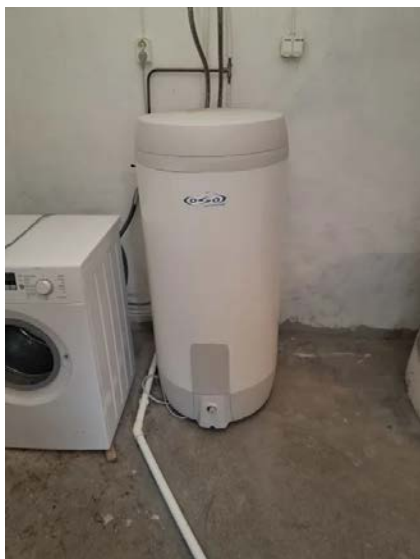
Varmtvannsbereder er plassert i vaskeskjeller.
