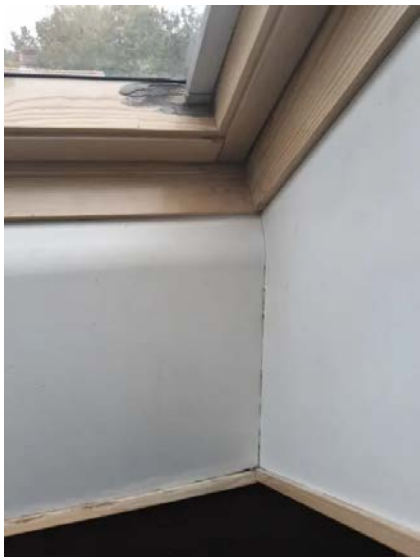
Fuktmerker i karm og foring til takvindu.
