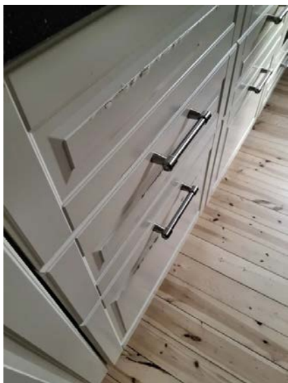
Det registreres folieslipp på enkelte fronter.
