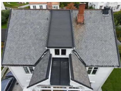
Det er ikke etablert snøfanger på taket.
