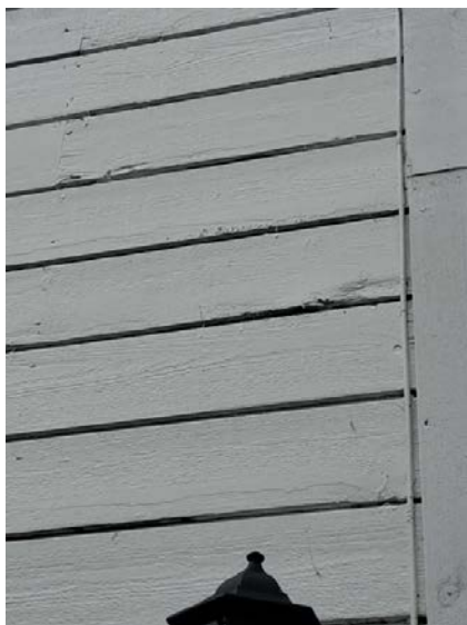
Det registreres tegn til påbegynnende råteskader på deler av kledningen.
