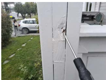
Det registreres stedvise råteskader.
