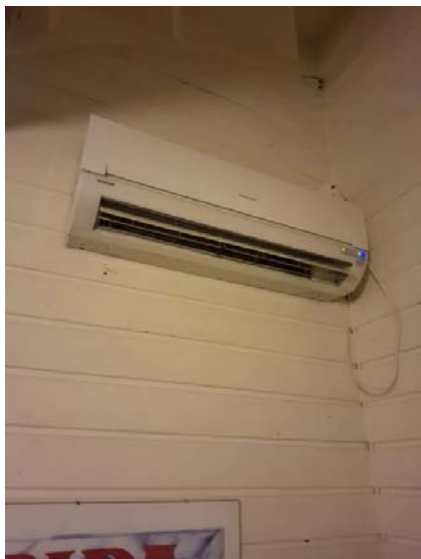
Eldre varmepumpe i trappegang.
