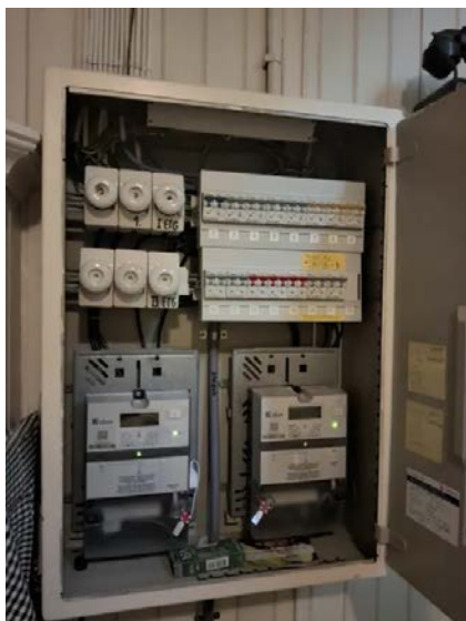
Sikringsskap er plassert i trappegang.
