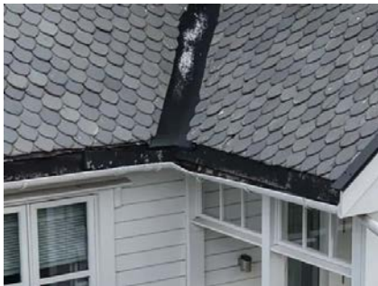
Det registreres skjevheter i takrenne.
