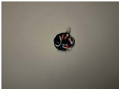
Manglende lokk på koblingsboks.
