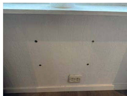
Skruehull i vegg
