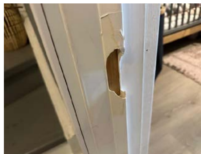
Skade i dørkarm til soverom.
