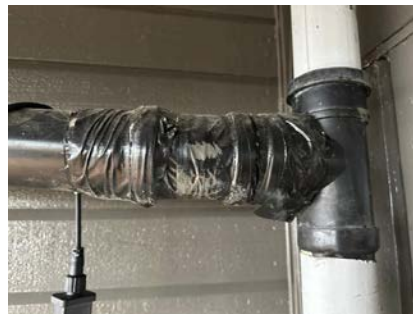
Teip på nedløpsrør
